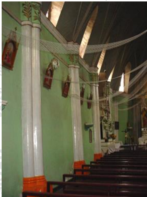
Ilustración 29. Muro de la Epístola
