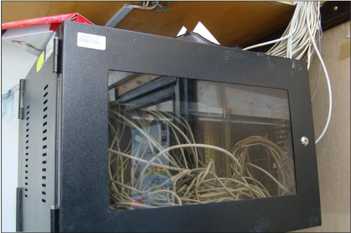
Rack del quinto piso - Edificio A
