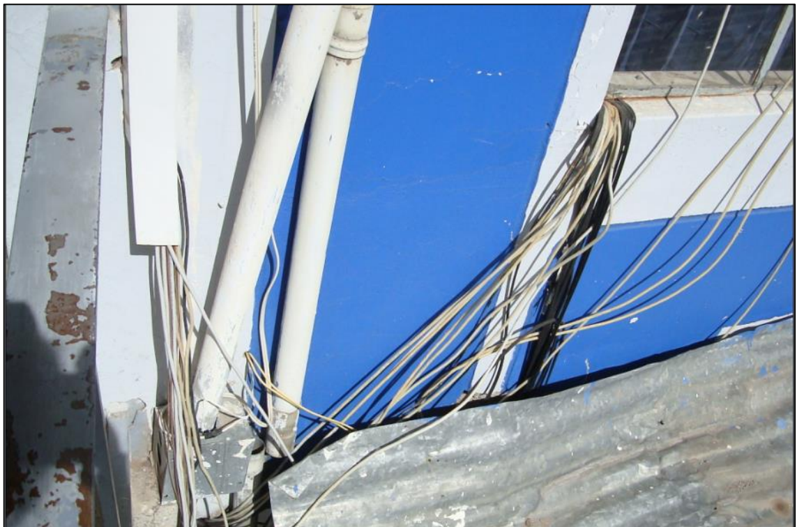
Cables expuestos al exterior del edificio A
