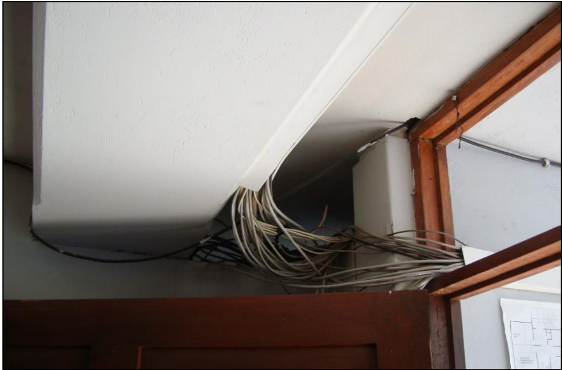
Cables expuestos en el tercer piso - Edificio A
