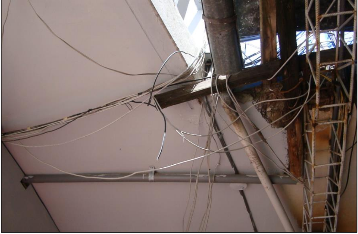
Cables expuestos en el segundo piso – Edificio A
