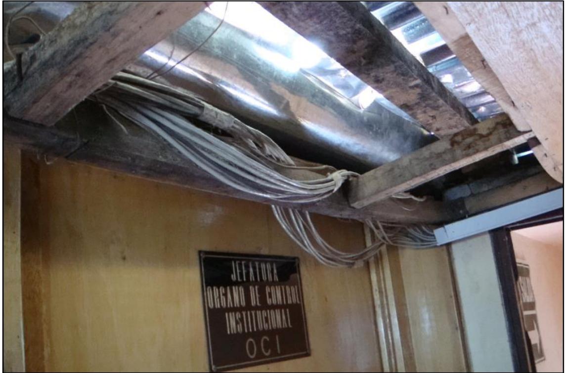
Cables expuestos en el tercer piso – Edificio B
