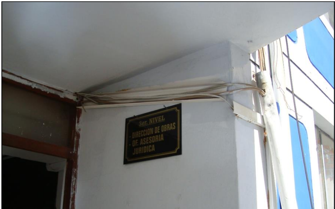
Cables expuestos – Edificio A
