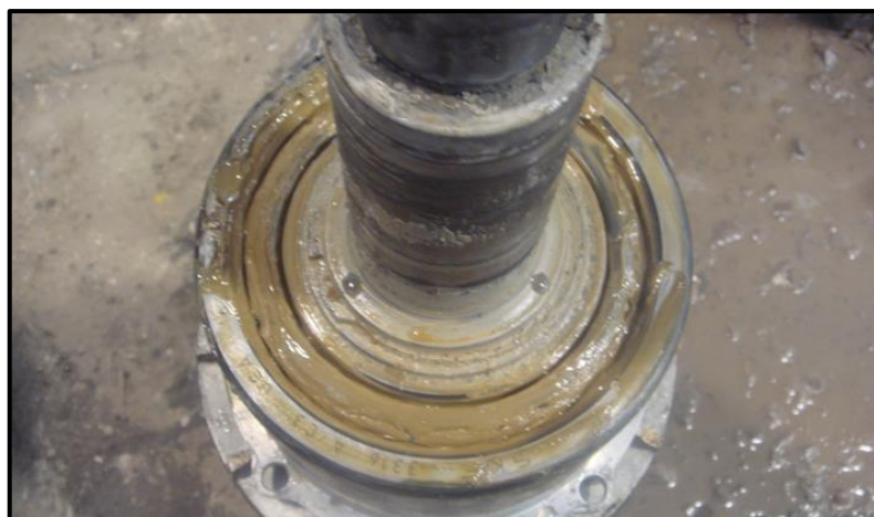
Figura 39. Grasa del rodamiento inferior contaminada por ingreso de agua y partículas abrasivas
