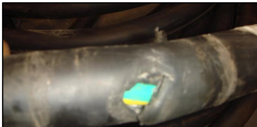
Figura 33. Corte de cable de fuerza Fuente: Propio
