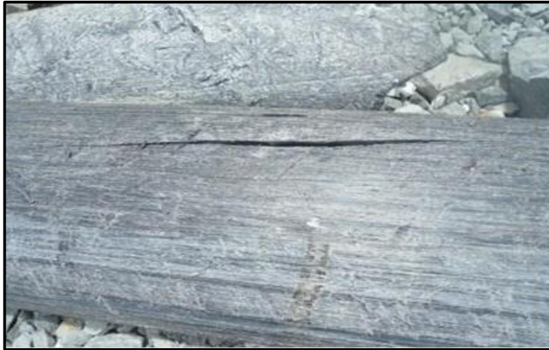
Figura 31. Tubería HDPE rota.
