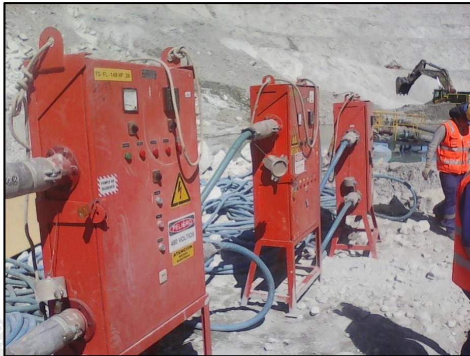
Figura 46. Tableros de bombas sumergibles MT
