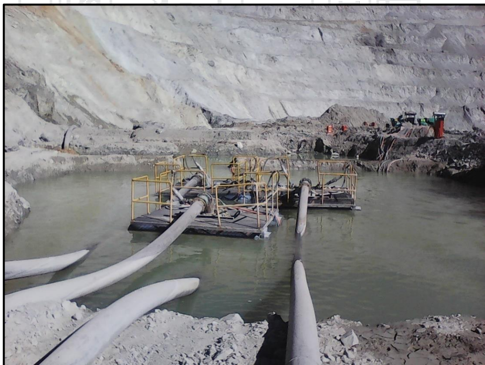
Figura 45. Bombas gorman rupp 275 hp con líneas de tubería HDPE Fuente: Propio
