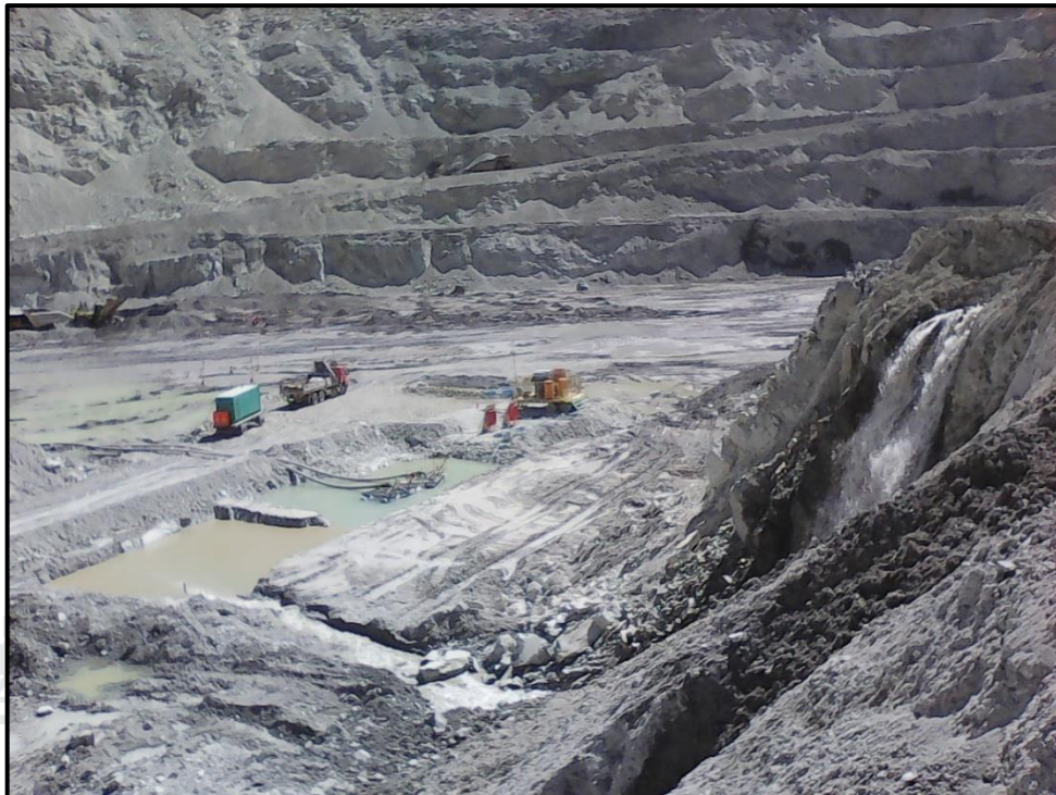
Figura 44. Posas utilizadas para bombeo Fuente: Propio
