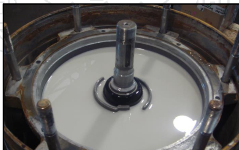
Figura 38. Aceite emulsionado por ingreso de agua Fuente: Propio
