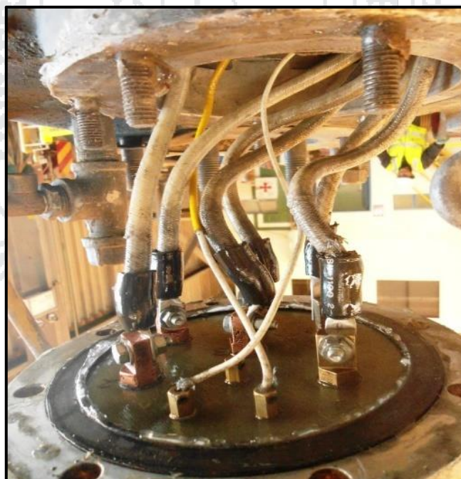
Figura 28. Caja de conexión con agua Fuente: Propia
