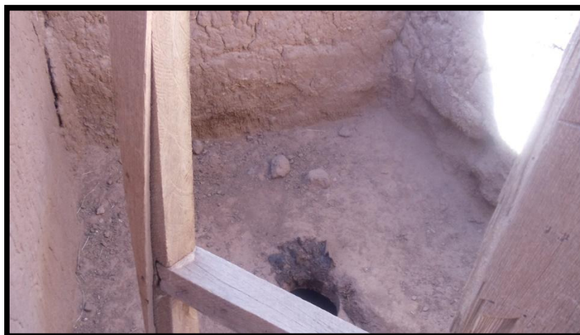
Figura N° 58: Letrina con Muros de Adobe Sin Puerta – Sector Aricoma (Visita a Campo)
