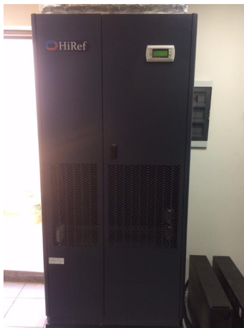
Figura 5: Sistema de enfriamiento de precisión HiRef Fuente: Estándar TIA 942 Elaboración: Propia
