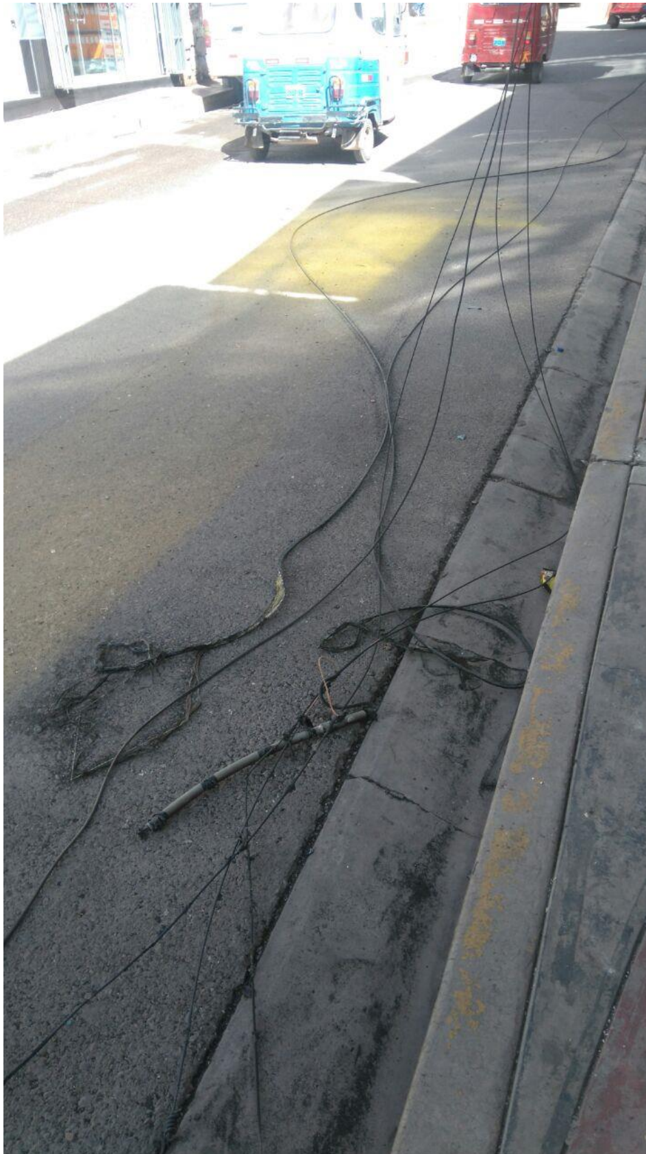
Anexo 2: Fibra Óptica quemada tirada en el suelo.
