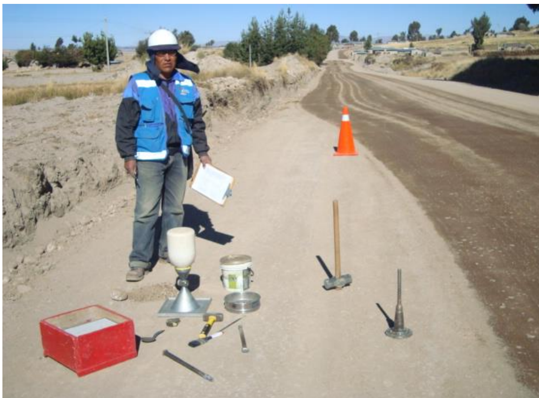
Foto N° 09. Control de densidad de campo in-situ, método: cono de arena. Estos controles se realizan en capas de Sub-rasante, Sub-Base y Bases granulares.
