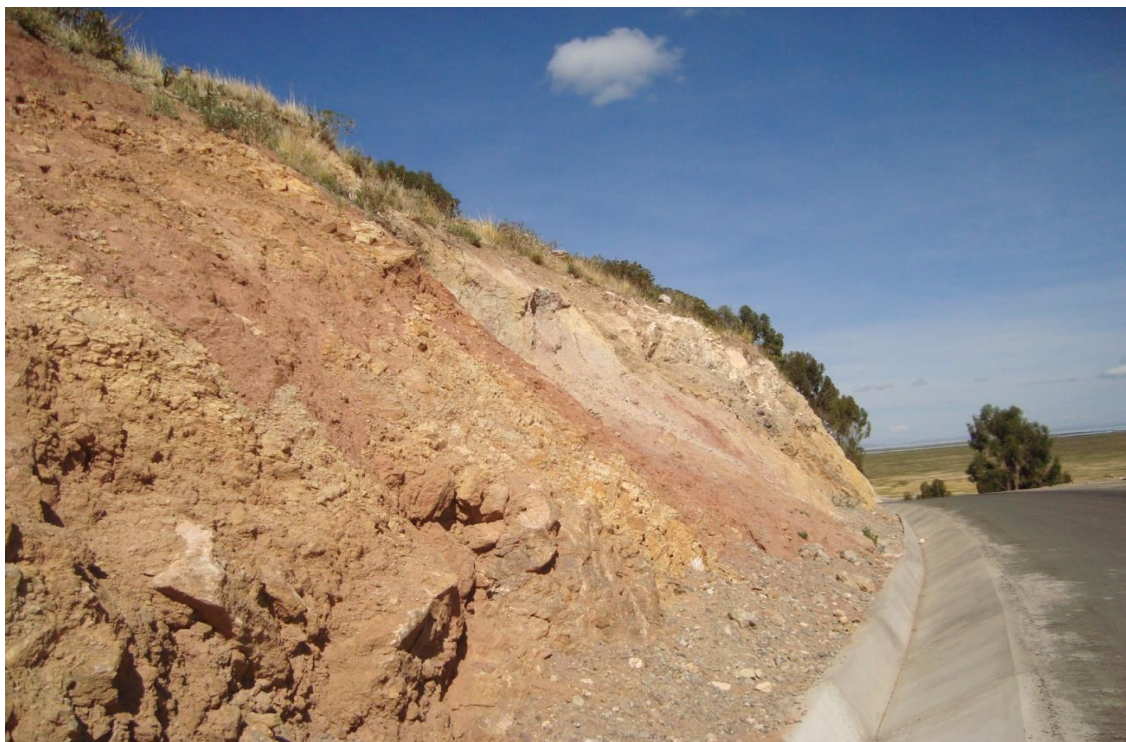
Foto N° 08. Zona inestable en casos de Sismos y/o por exceso de precipitación pluvial en la zona. (Km. 6+400, Estación N° 2)
