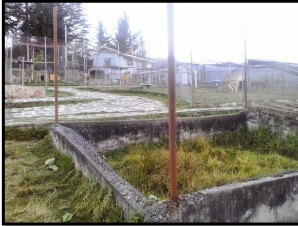
IMAGEN N° 64 VISTA DE JAULAS DETERIORADAS
