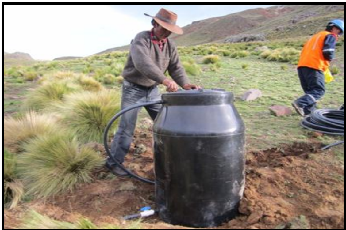
Instalación de agua para uso familiar en la comunidad de Parina
