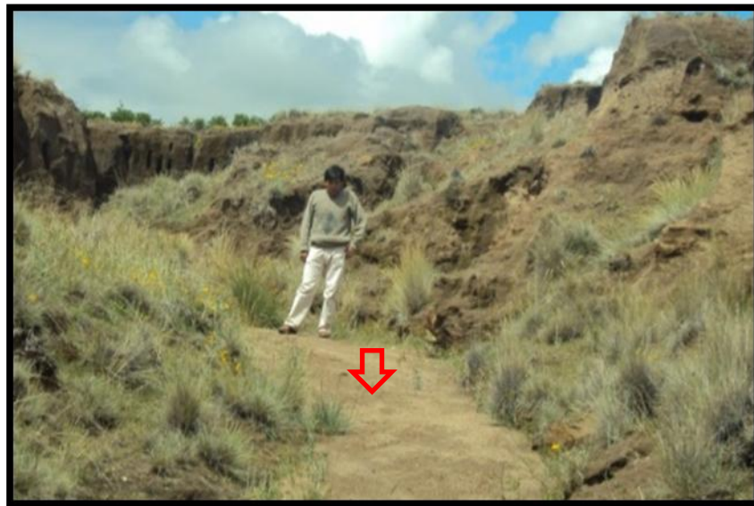
Figura 7: Profundización de fondo de la cárcava.
