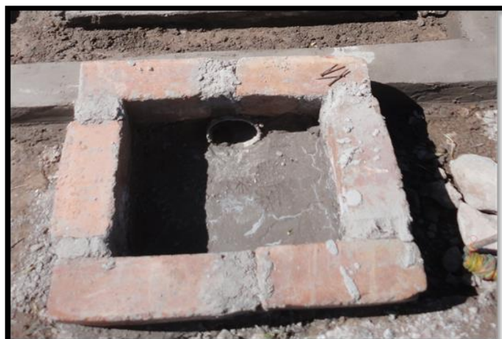
FIGURA 14. Caja de ingreso al biodigestor
