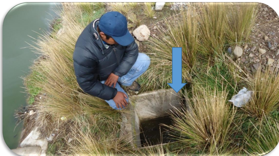
FOTO N° 02: Se observa caja de ingreso a la laguna primaria N° 01 de la PTAR sin ningún tipo de control de ingreso, ni tapa de concreto, esto perjudica el buen funcionamiento de la PTAR.
