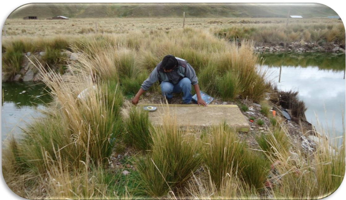
FOTO N° 04: Se observa la recolección de datos y el diagnóstico de las cámaras o vertedores de conexión entre las lagunas primarias N° 01 y secundarias N° 03 de la PTAR del distrito de Ajoyani.
