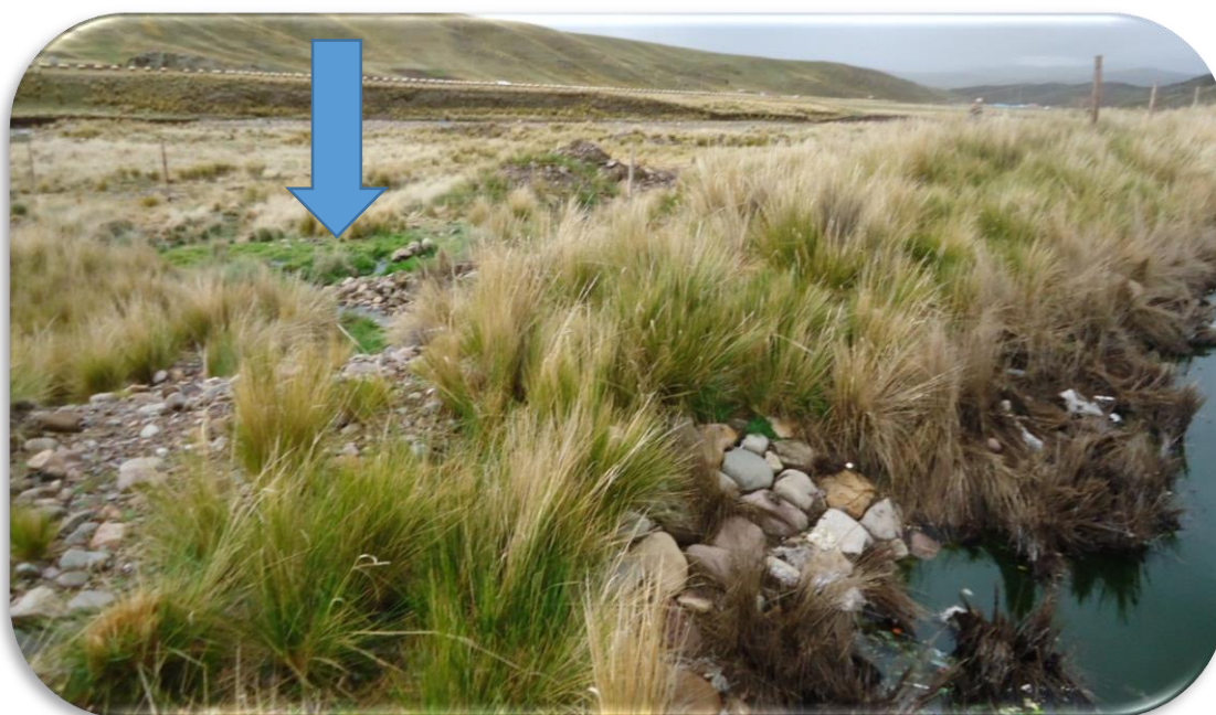
FOTO N° 06: Se observa la filtración de agua residual por el talud de la laguna primaria N° 02, escurriendo directamente al río.
