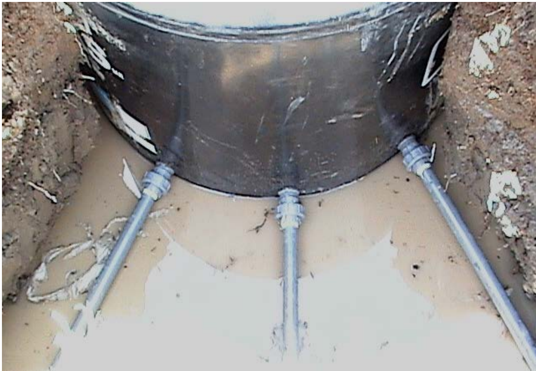
Foto 03: Conexión de tubos PVC Ø 1 Pulg. al tanque de control de lectura.
