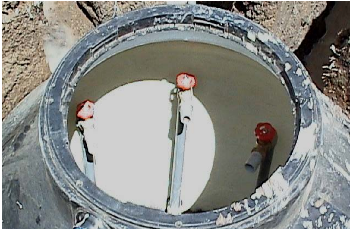
Foto 05: Vista de las Válvulas de drenaje de los Lisímetros L1, L2 y L3.
