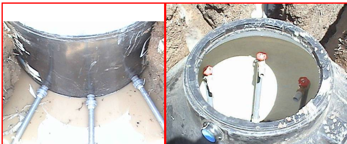
Foto 02. Conexión de tubería de los lisímetros al tanque de lectura con sus respectivas llaves de paso.
