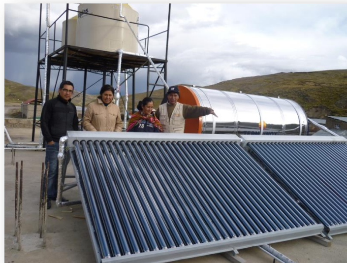
IMAGEN 02: Módulos colector solar con tubos al vacío y termo tanque.
