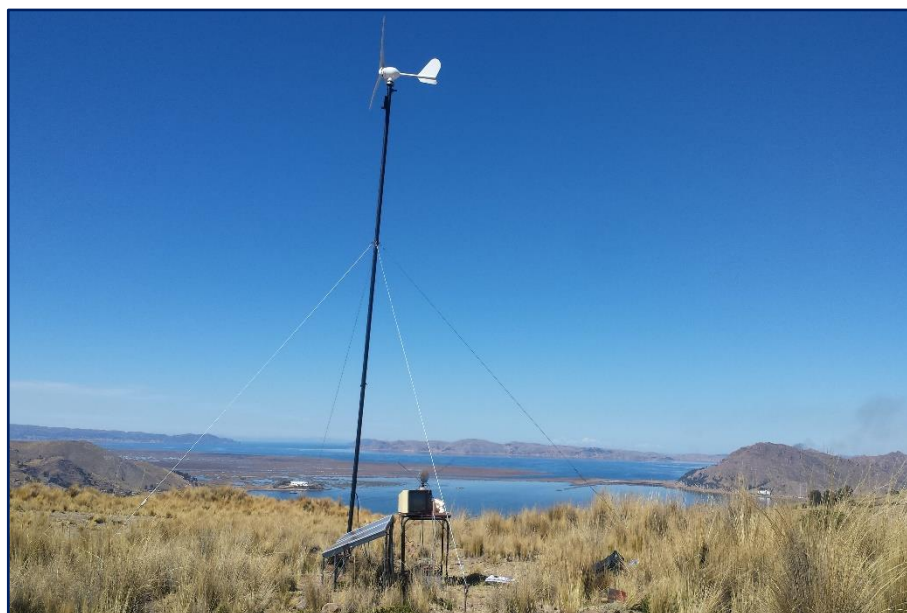
Figura 47: Instalación Completa del Módulo Híbrido
