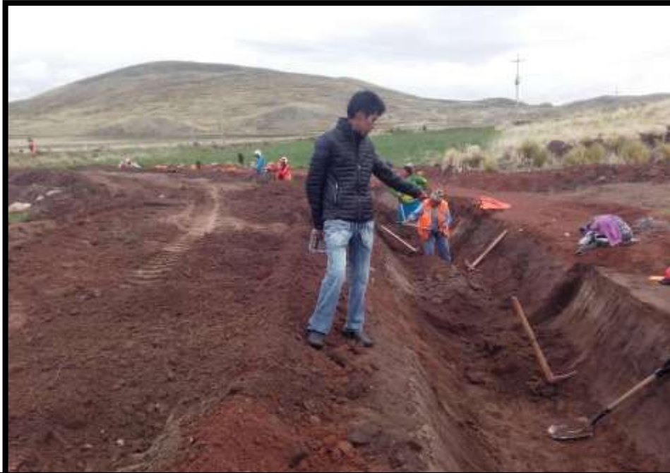
SE MUESTRA TRABAJOS DE LA PARTIDA EXCAVACIÓN DE CAJA CANAL A MANO EN MATERIAL SUELTO
