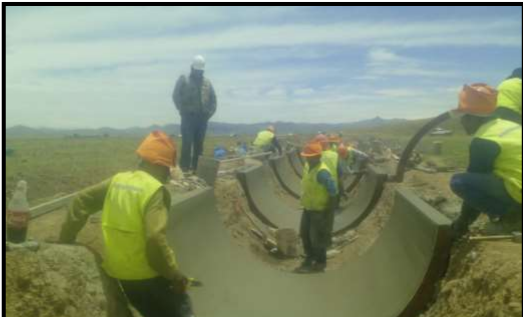
SE MUESTRA TRABAJOS DE LA PARTIDA CONCRETO F'c=175\text{Kg/cm}^2 PARA REVESTIMIENTO DE CANALES
