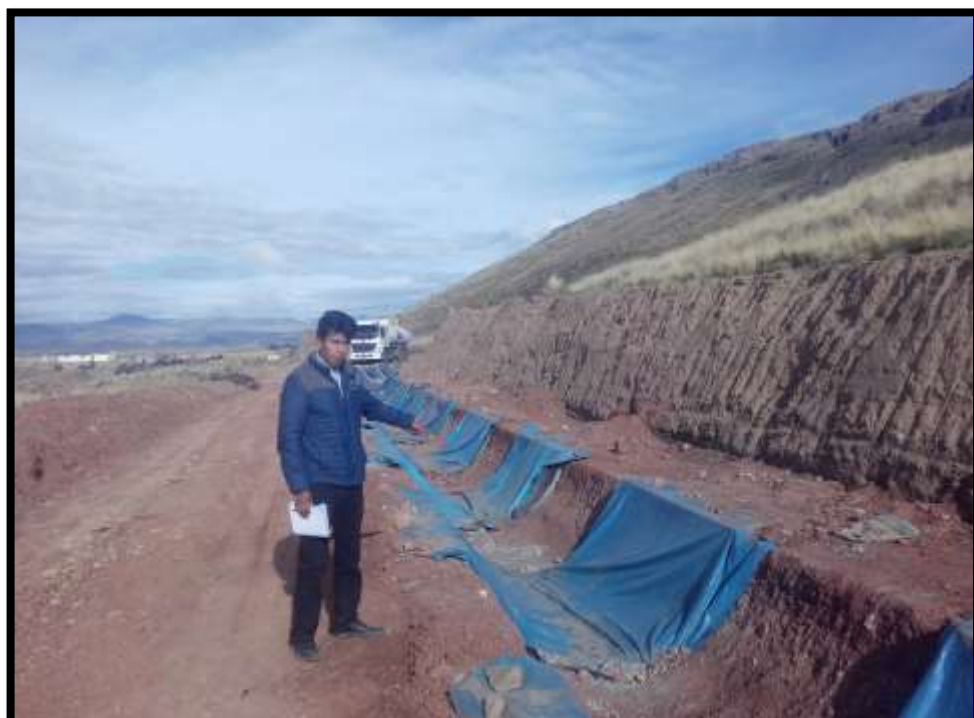
SE MUESTRA TRABAJOS DE LA PARTIDA CONCRETO F'C=175\text{kg/cm}^2 PARA REVESTIMIENTO DE CANALES
