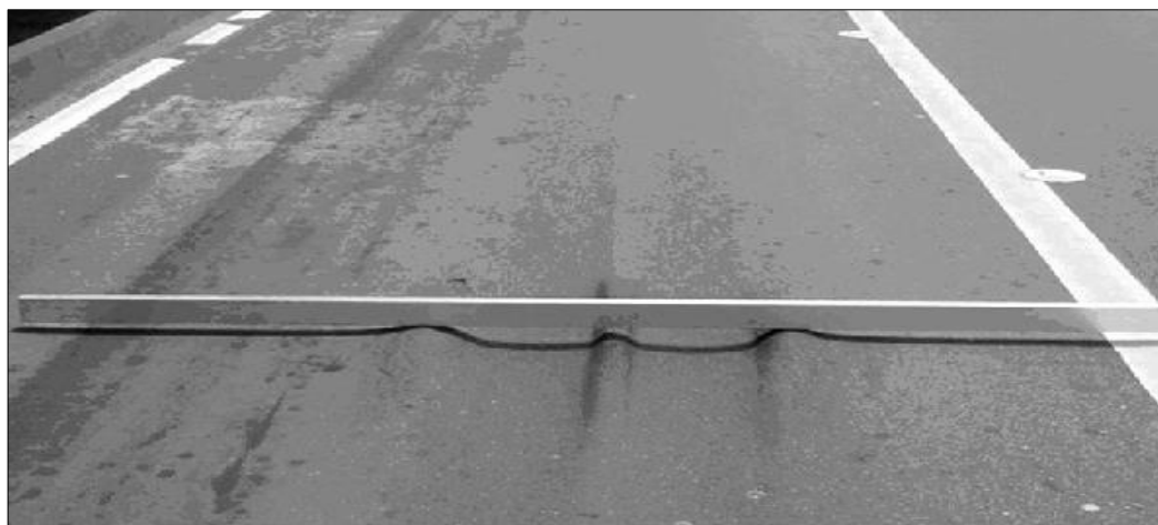
Figura N° 2. 11. Ahuellamiento o Deformación Permanente o Rutting
