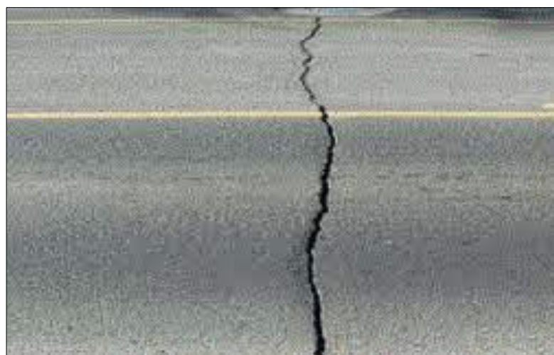
Figura N° 2. 12. Agrietamiento por bajas temperaturas
