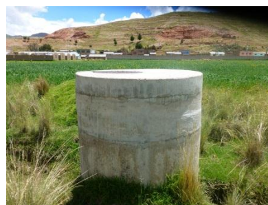
IMAGEN N° 28: SERVICIO DE DESAGÜE
