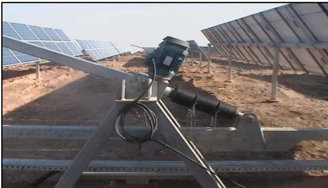
Figura 39: Soportes utilizados en los paneles solares.
