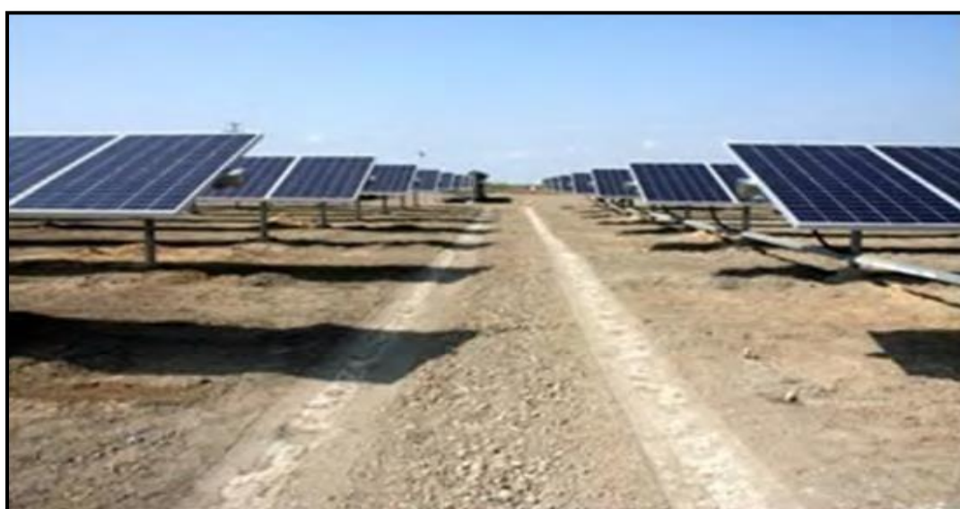
Figura 23: instalaciones de módulos fotovoltaicos
