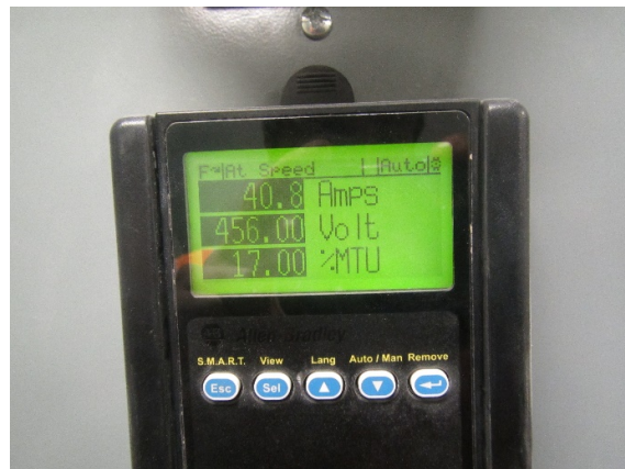
Figura 16. Extracto del Reporte entregado por display de medición del CCM Despacho de bombonas.
