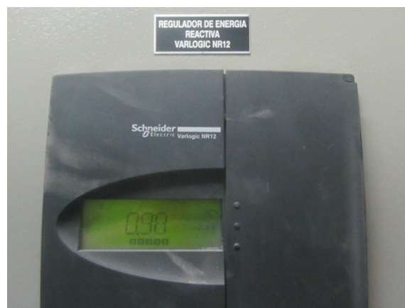
Figura 17. Extracto del Reporte entregado por display de medición del regulador de energía conectado en la sala Haver 4.
