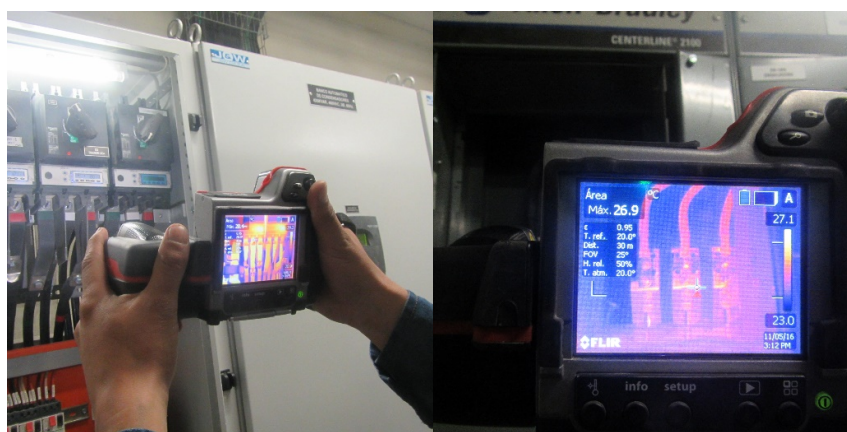
Figura 21. Prueba termográfica en la barra de alimentación del TD Haver 4
