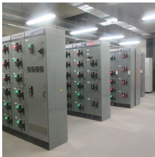
Gráfico 12. Centro de control de motores Allen Bradley
