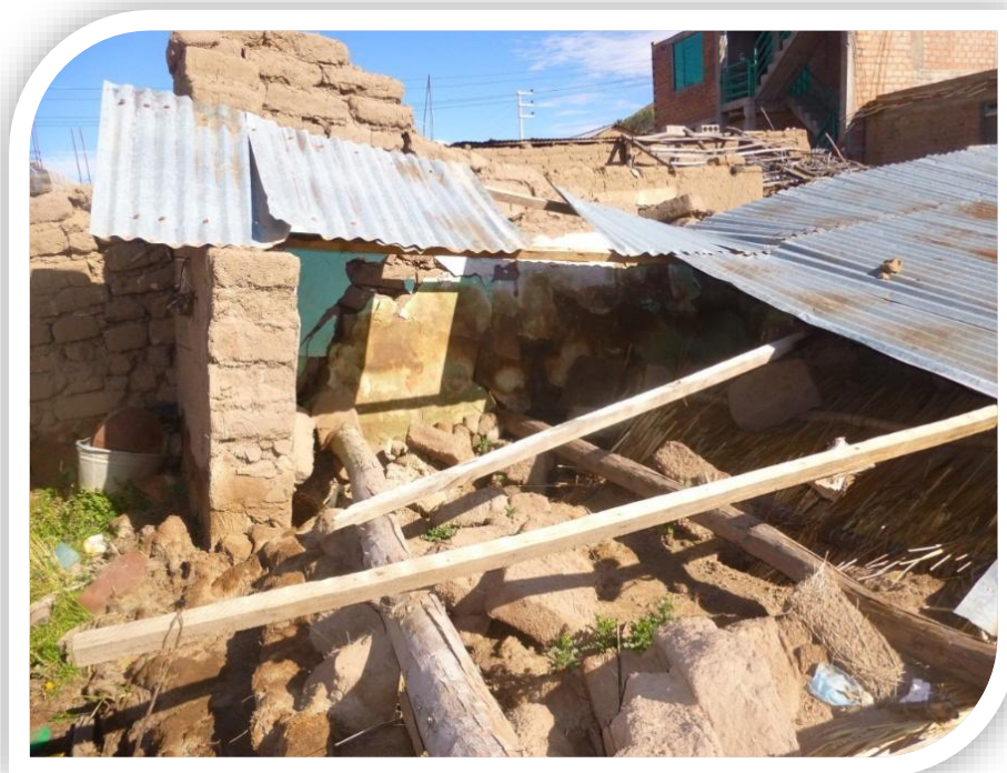
Figura 59: Desprendimiento originado por las inundaciones
