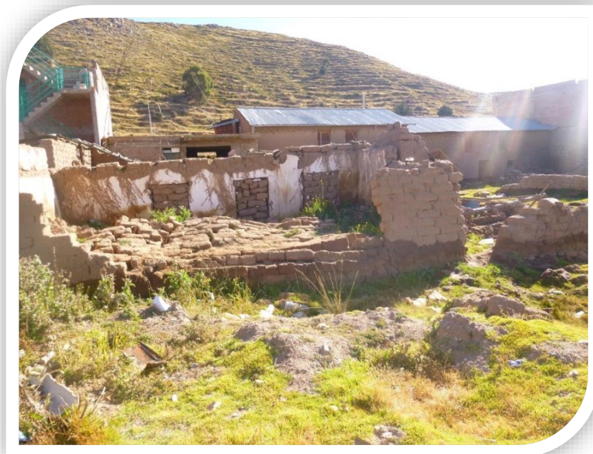
Figura 58: Desplome de vivienda en Chupa
