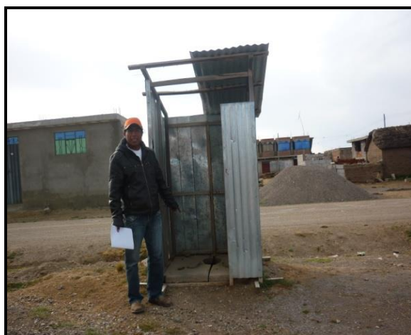
FOTO N° 04: En la imagen se observa una letrina En mal estado.
