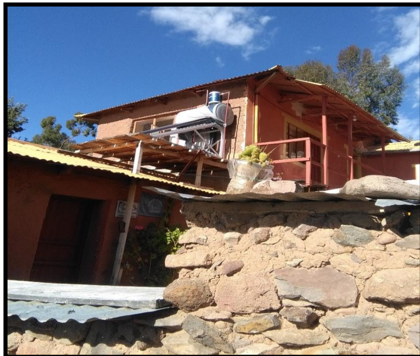
Figura 15: Panel y Terma solar
