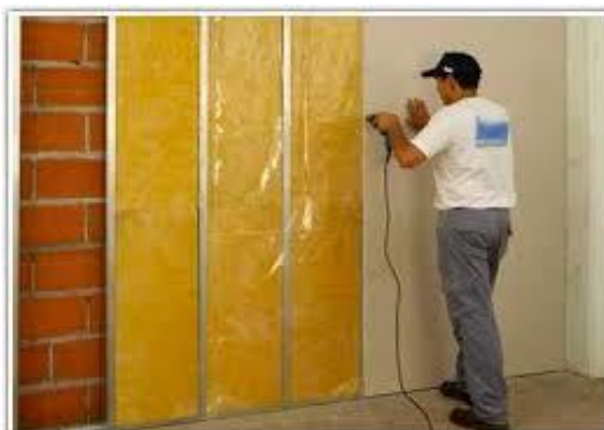
FIGURA 94: FIBRA DE LANA DE VIDRIO EN PAREDES
