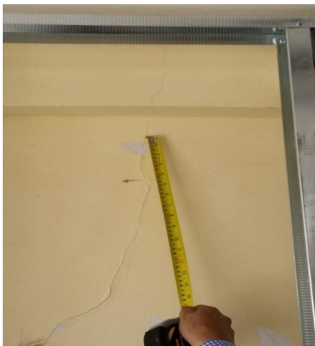
Figura N°01: Fisura en muro perimetral (Albañilería) 2° Nivel
