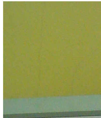
Figura N°06: Fisura en tabique de cierre perimetral - Cuarto Nivel
