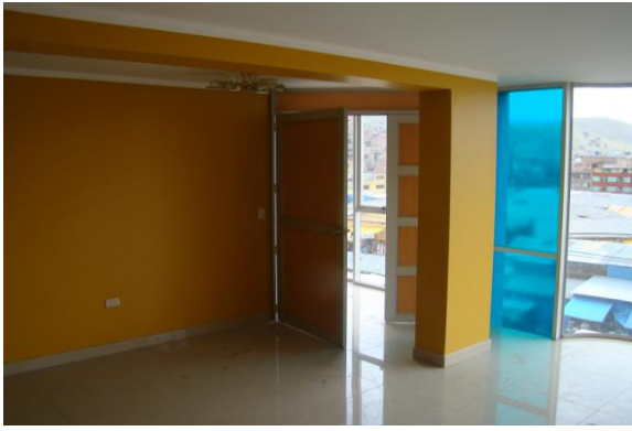
Figura N°03: Estado de las estructuras Cuarto Nivel
