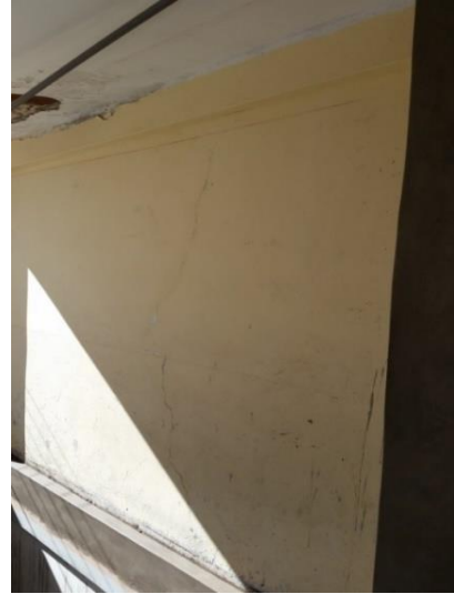
Figura N°03: Fisura en muro de cierre 2° Nivel
