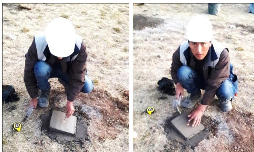
Figura 42. Replanteo de los ejes de T-01 al T-18 sobre los puntos materializados. Fuente: Elaboración Propia.
