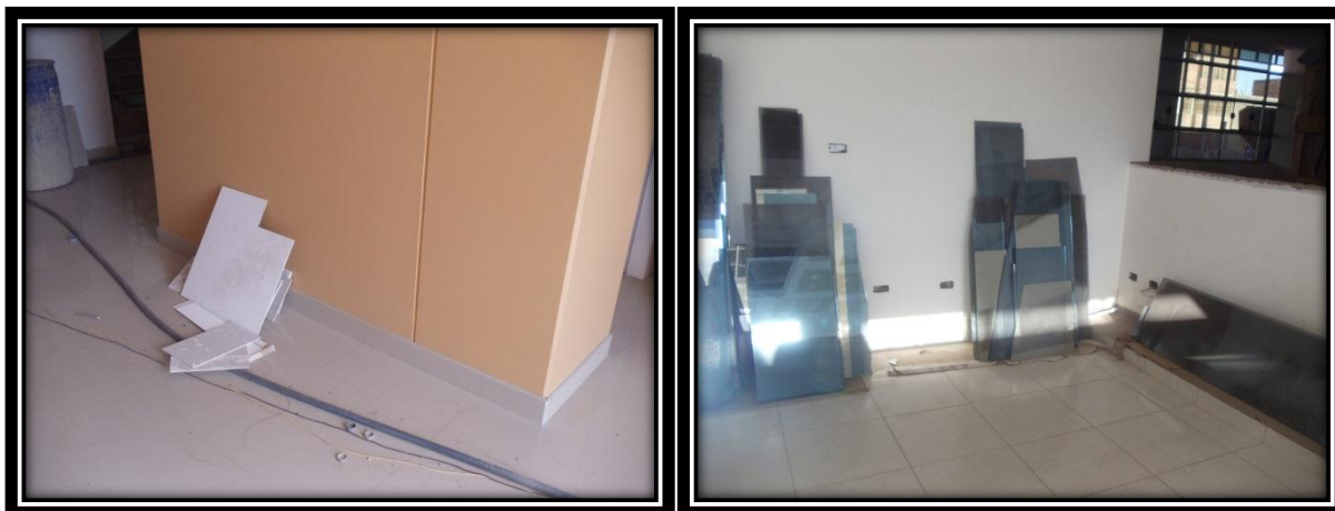
Izquierda: Superboard para cielorraso inservible en interior 2do nivel sector “B” Mega Laboratorio Clínico
