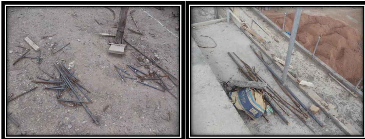
Izquierda: Retazos de acero de refuerzo en 3er nivel Tribuna Oriente Complejo Deportivo Universitario
