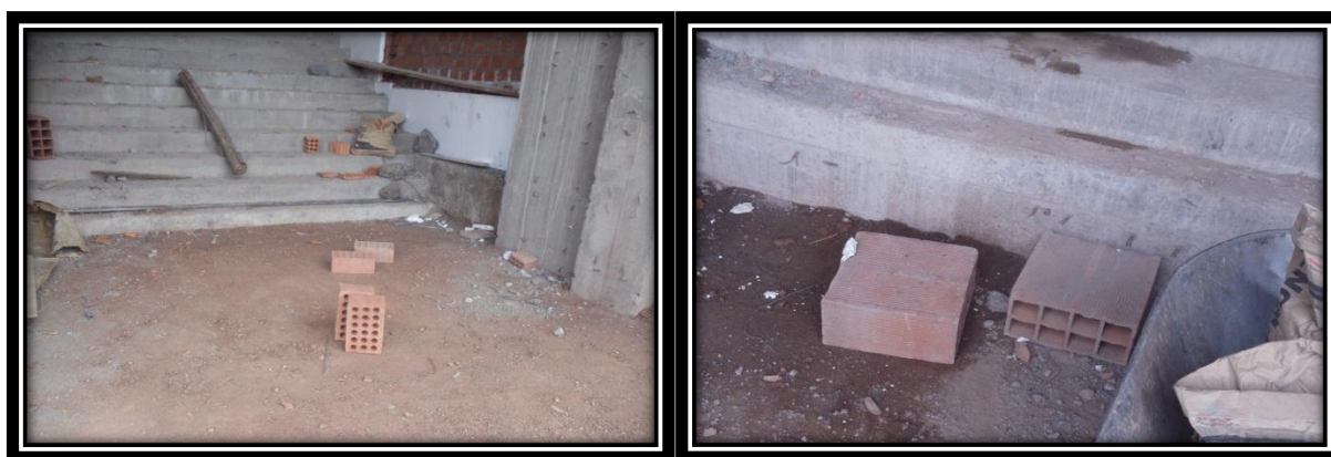
Figura N° 42: Ladrillos inservibles: (a) Izquierda: Ladrillo King Kong para muros de albañilería. (b) Derecha: Ladrillo 8 huecos para aligerado
