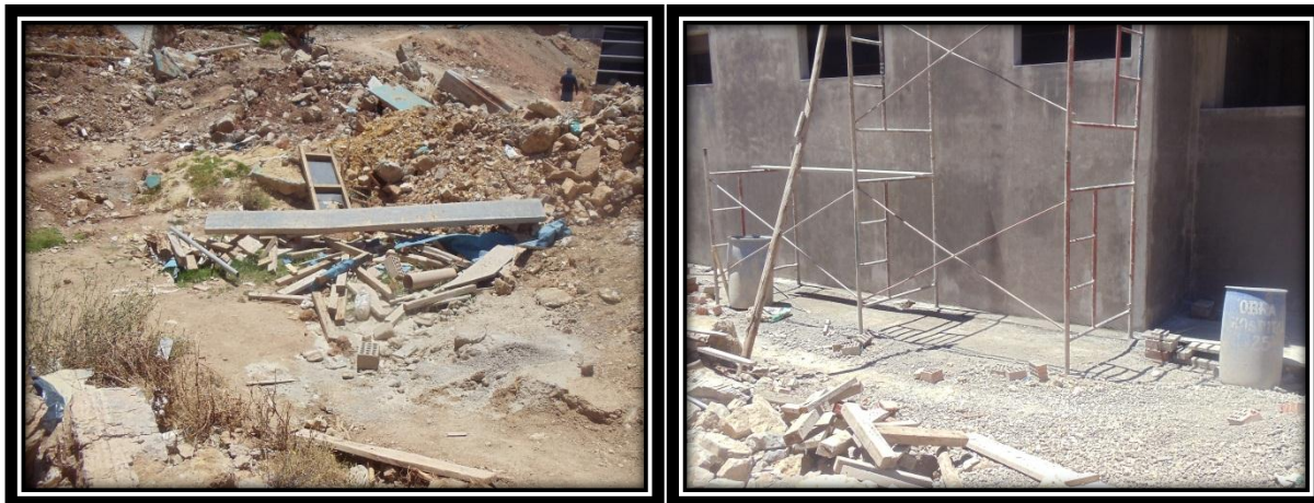
Izquierda: Retazos de madera en campo de obra entre sectores “E” y “H” Mega Laboratorio Clínico
