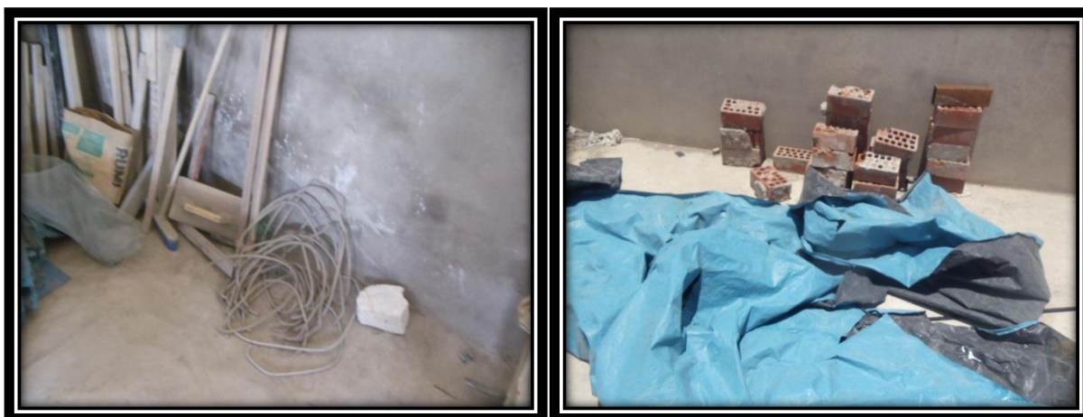
Izquierda: Retazos de acero de refuerzo en interior ambiente almacén sector “F” Mega Laboratorio Clínico
