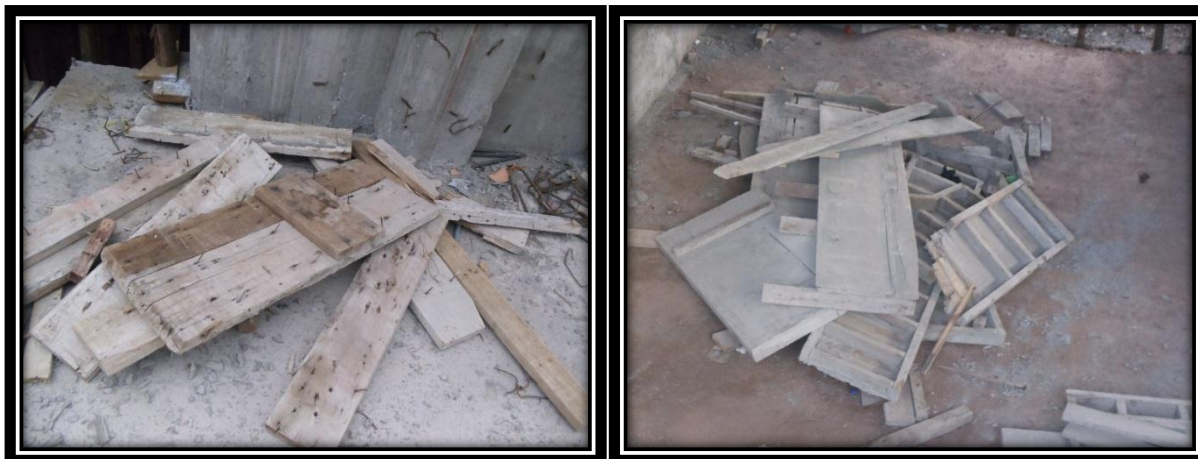
Izquierda: Encofrados no reutilizables en descanso escalera acceso 3er nivel Tribuna Sur Complejo Deportivo Universitario
