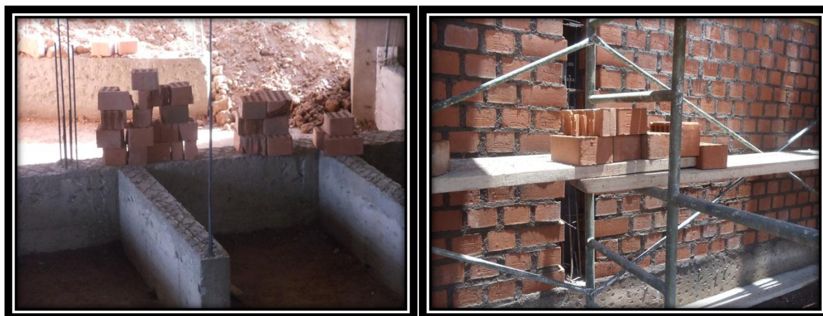
Izquierda: Ladrillos King Kong para albañilería inservibles en interior 1er nivel Tribuna Sur Complejo Deportivo Universitario
