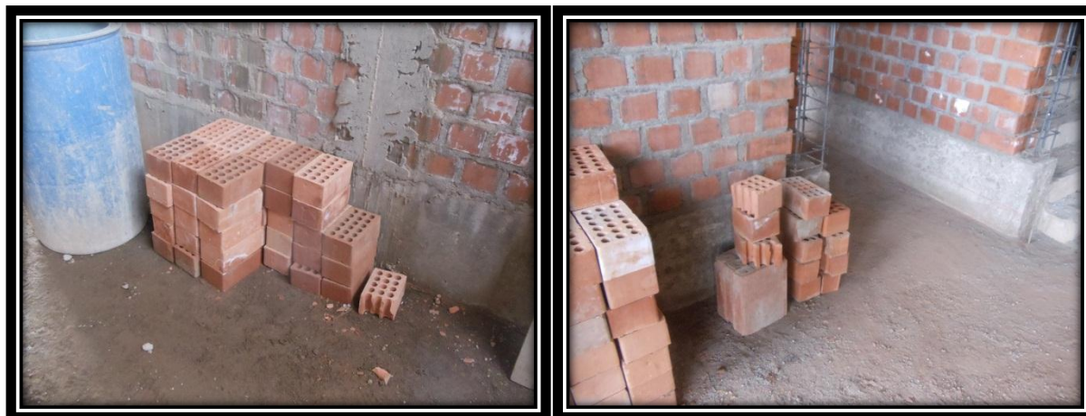
Izquierda: Ladrillos King Kong para albañilería inservibles en interior 1er nivel Tribuna Oriente Complejo Deportivo Universitario
