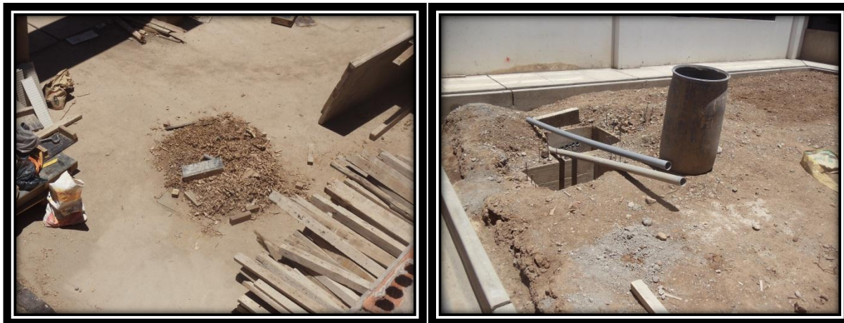
Izquierda: Madera en polvo (Aserrín) en campo de obra entre sectores “A” y “F” Mega Laboratorio Clínico
