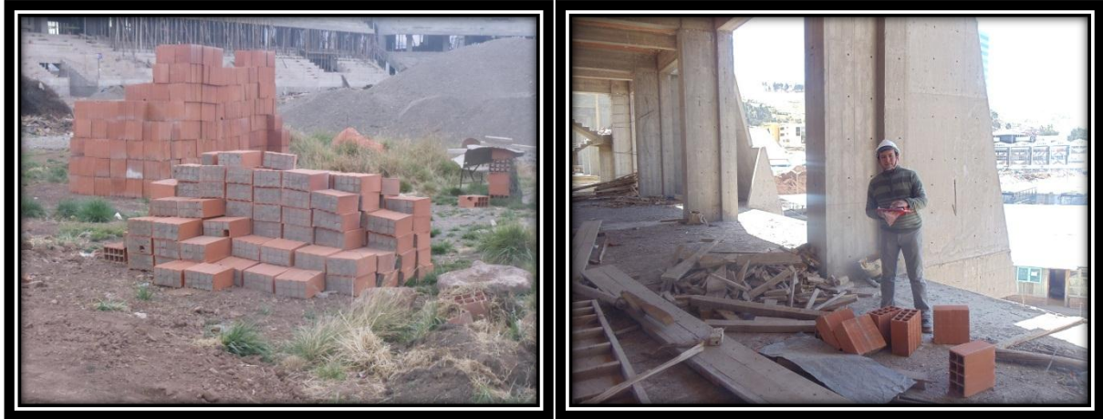
Izquierda: Ladrillo hueco para aligerado inservible en el centro de campo de obra Complejo Deportivo Universitario
