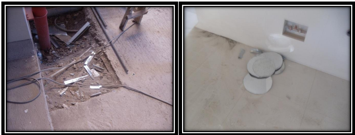
Izquierda: Perfiles para cielorraso inservibles en 1er nivel pasadizo sector “E” hacia sector “B” Mega Laboratorio Clínico
