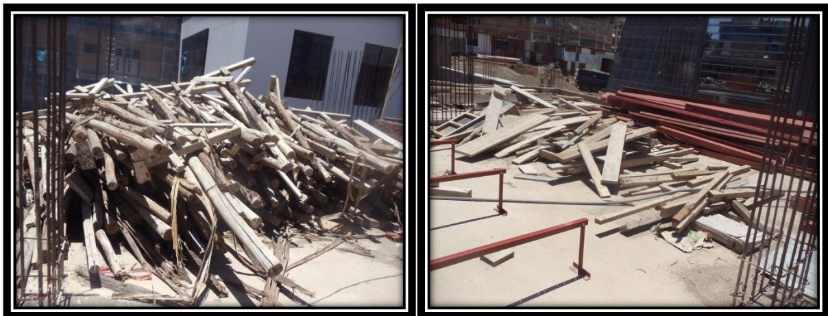
Izquierda: Rollizos no reutilizables en el 2do nivel sector “E” Mega Laboratorio Clínico
