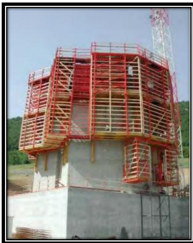
Figura N° 65: Encofrado metálico para una columna de sección variable
