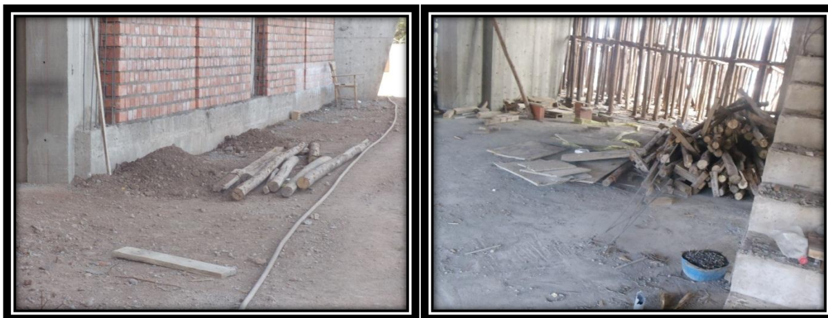
Izquierda: Rollizos de madera no reutilizables en exterior 1er nivel Tribuna Oriente Complejo Deportivo Universitario
