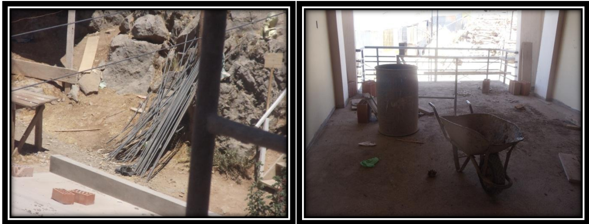
Izquierda: Retazos de acero de refuerzo en campo de obra taller de ferrería frente a residencia Escuela Profesional de Trabajo Social
