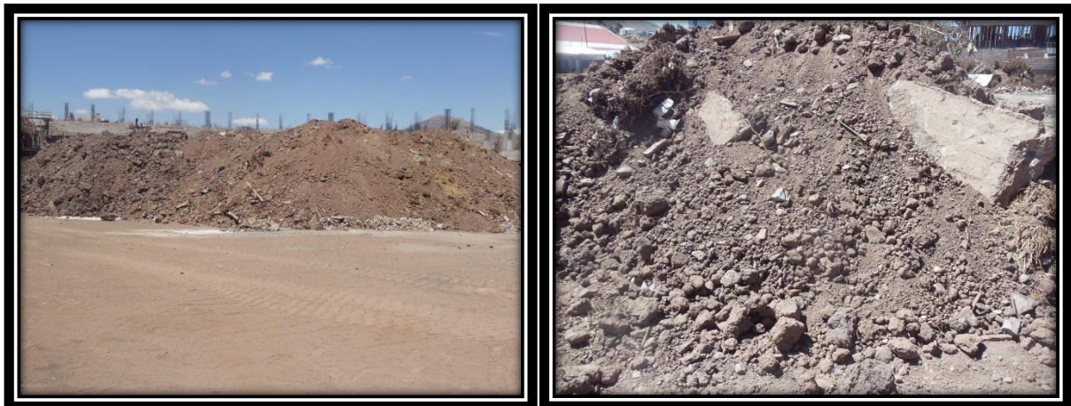
Izquierda: Material excedente de excavaciones en campo de obra Complejo Deportivo Universitario
