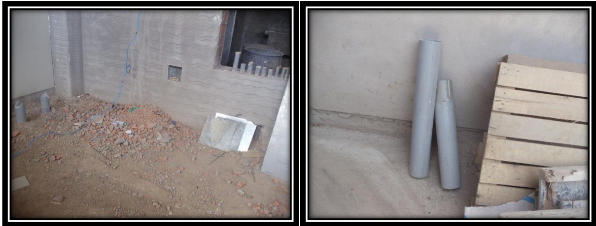
Izquierda: Material de escombros en interior 1er nivel sector "D" Mega Laboratorio Clínico
