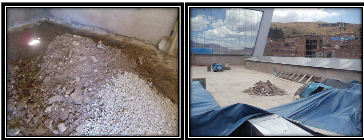
Izquierda: Material de escombros en interior 1er nivel sector "G" Mega Laboratorio Clínico
