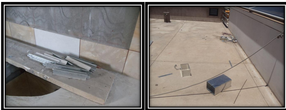
Izquierda: Perfiles para cielorraso inservibles en 3er nivel sector “B” ambientes laboratorios Mega Laboratorio Clínico
