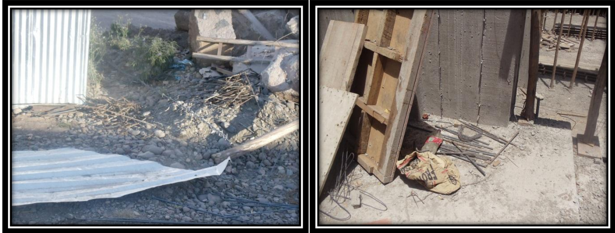
Izquierda: Retazos de acero de refuerzo en campo de obra en taller de ferrería Complejo Deportivo Universitario
