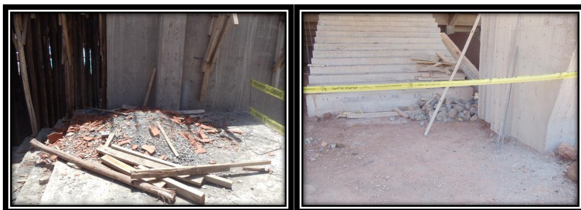
Figura N° 44: Material inservible: (a) Izquierda: Material de escombros. (b) Derecha: Grava no utilizada
