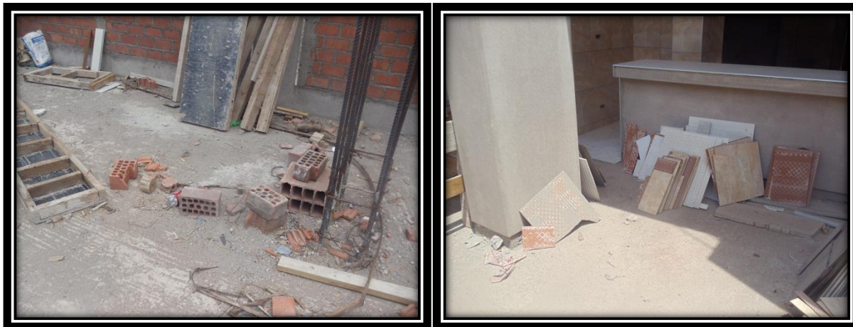
Izquierda: Ladrillos hueco y King Kong inservibles en 2do nivel sector “E” Mega Laboratorio Clínico
