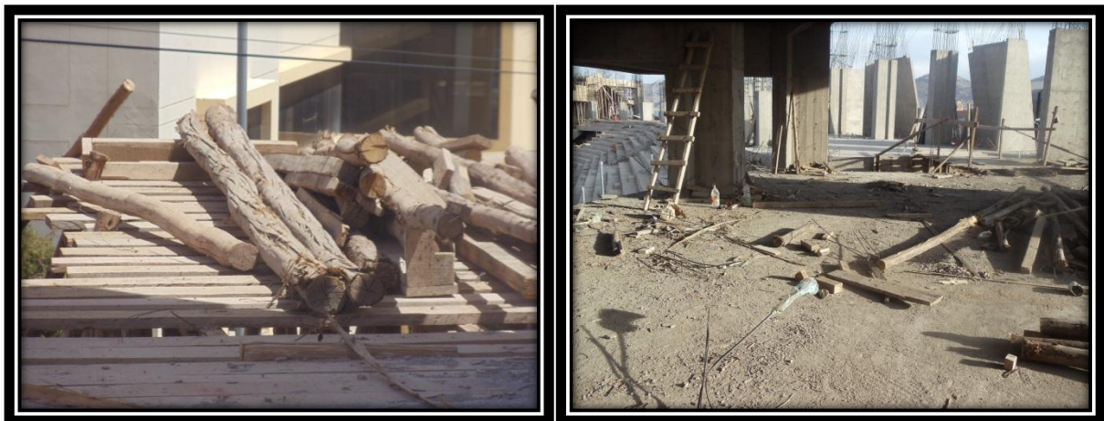
Izquierda: Rollizos no reutilizables en 2do nivel Tribuna Sur andamio Complejo Deportivo Universitario
