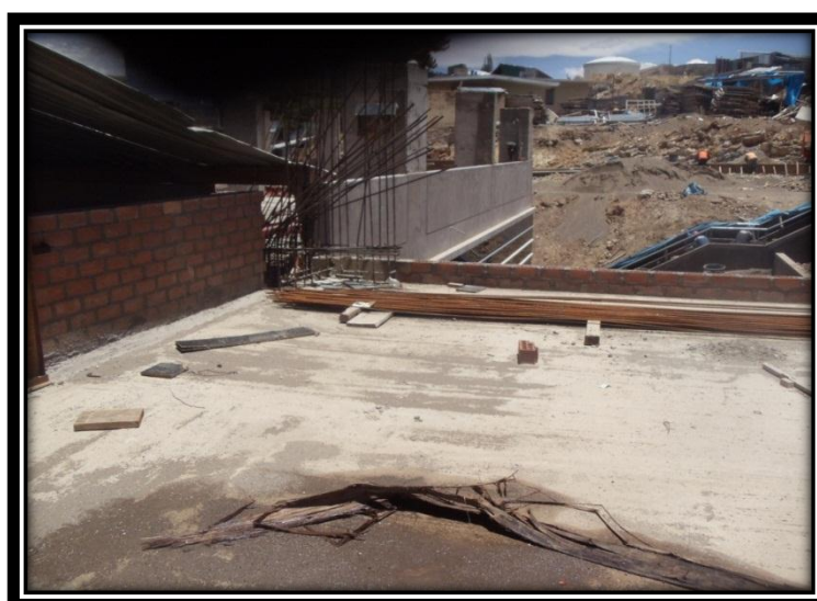
Figura N° 5: Pérdidas de varillas de acero por espera en Mega Laboratorio Clínico
