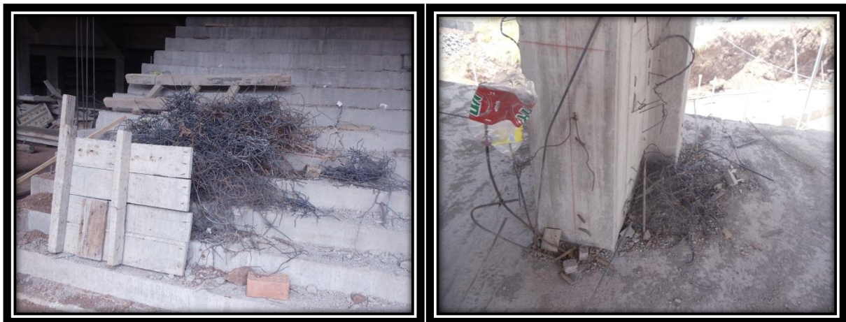
Izquierda: Alambres para encofrado inservibles en escalera 1er nivel Tribuna Occidente Complejo Deportivo Universitario
