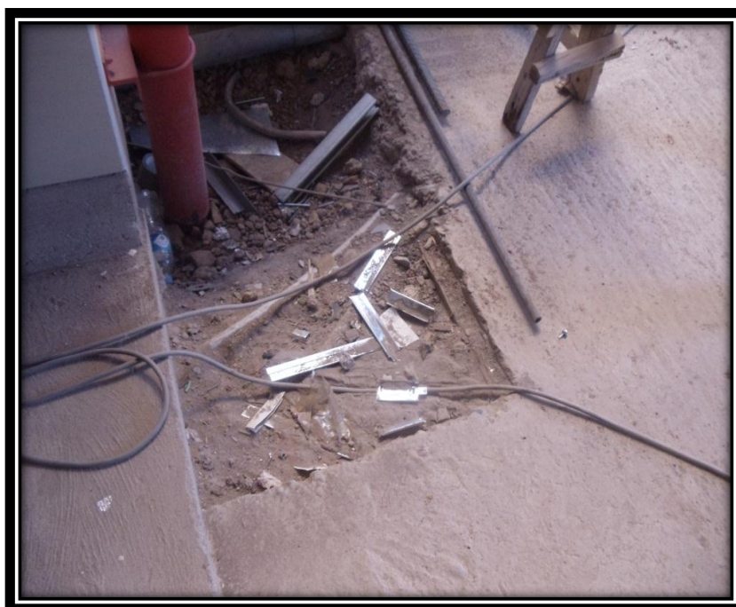
Figura N° 46: Perfiles para cielorraso inservible
