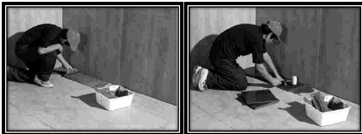
Figura N° 30: a) Izquierda: Colocado de palmetas. b) Derecha: Golpeado de palmetas para conseguir adherencia.
