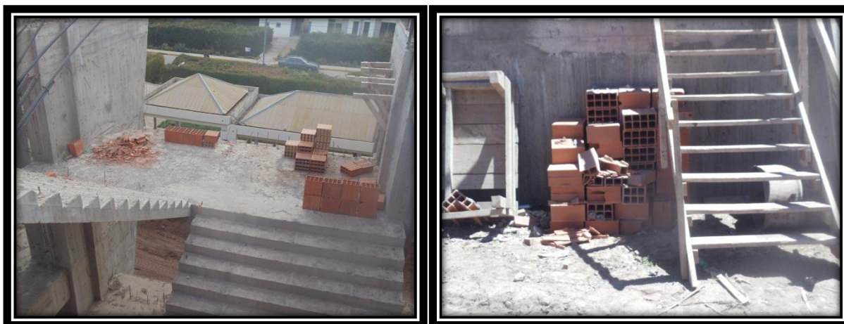
Izquierda: Ladrillo hueco para aligerado inservible en descanso escalera de acceso 3er nivel Tribuna Occidente Complejo Deportivo Universitario
