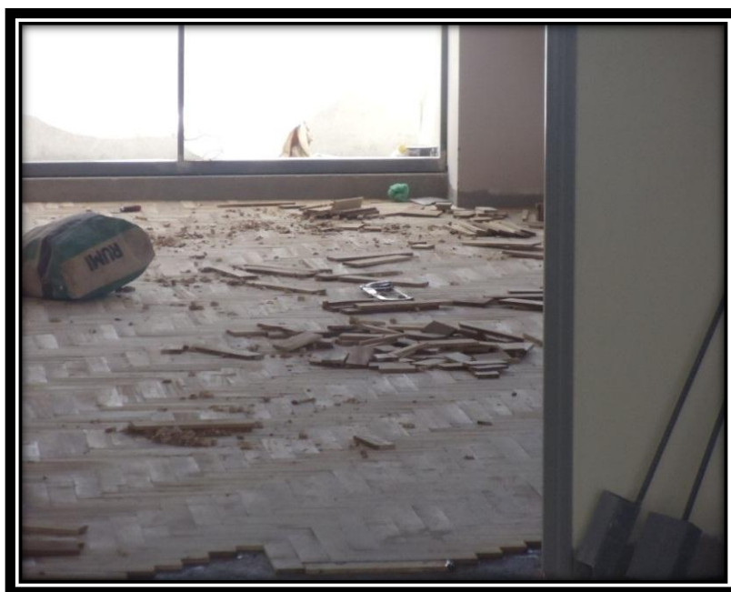
Figura N° 47: Trozos de parquet inservible
