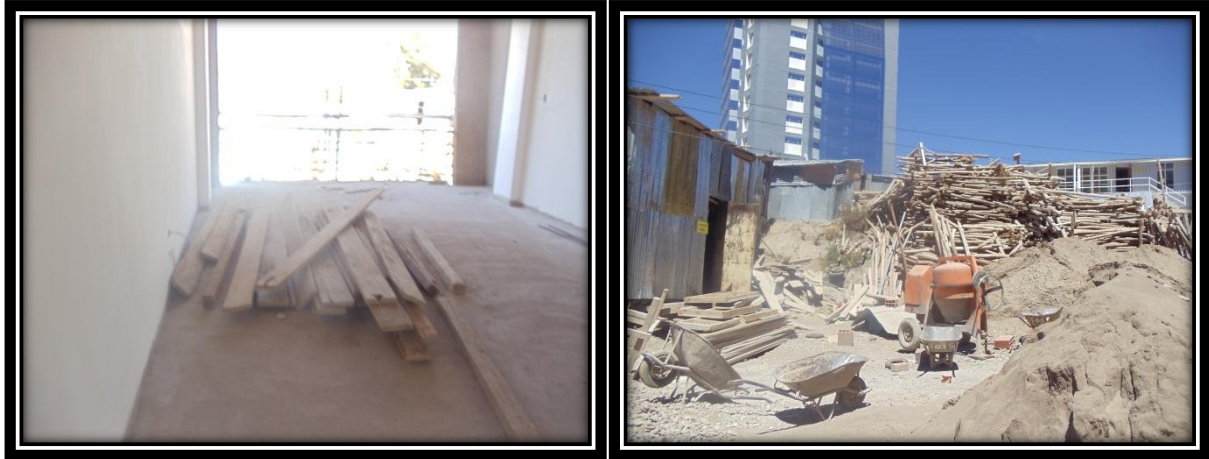
Izquierda: Tablas de encofrado no reutilizable en interior 2do nivel ambiente para docentes Escuela Profesional de Trabajo Social
