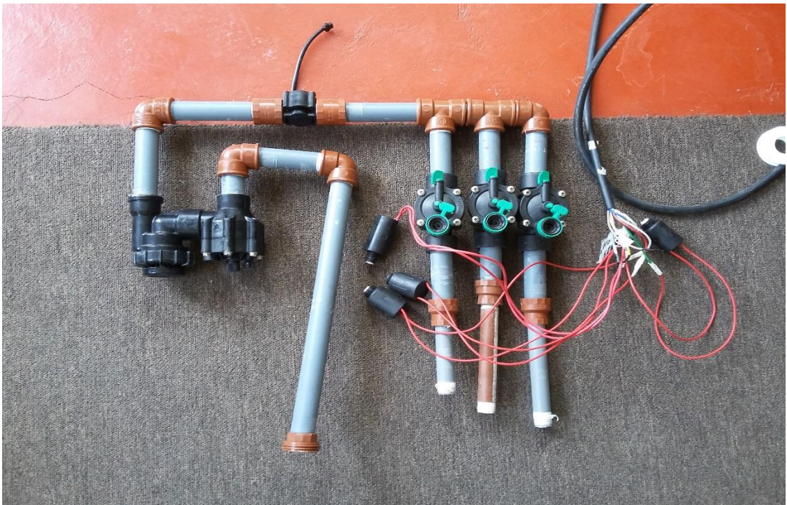
Tuberías y actuadores del proceso, fotografía tomada 11/10/2017.
