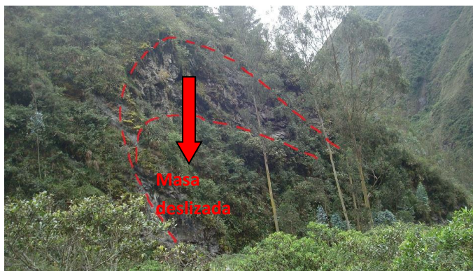
Foto N°1: Quebrada Osjo Cachi. Movimiento de Masas.
