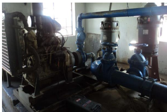
Figura 4. Estación de bombeo llave -2012
