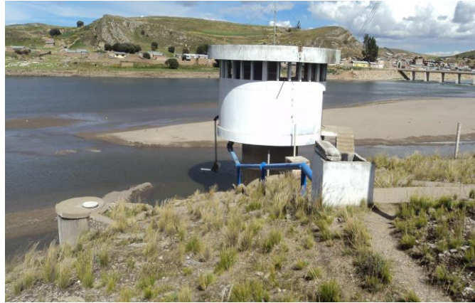
Figura 3. Captación de agua nueva, llave – 2012
