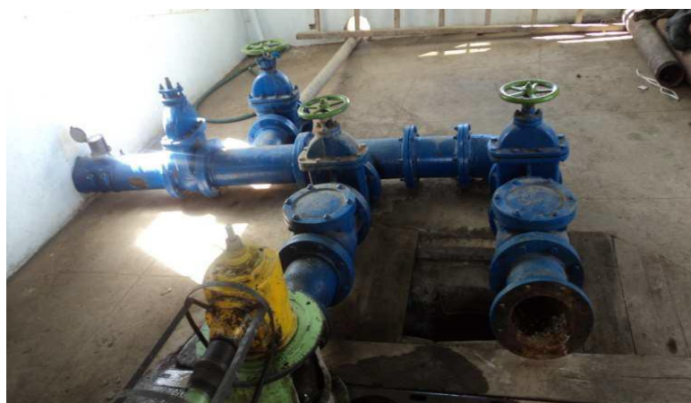
Figura 2. Impulsión de captación antigua llave – 2012.
