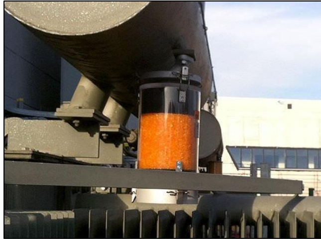
Figura 10: Secador de silica gel montado en un Transformador.
