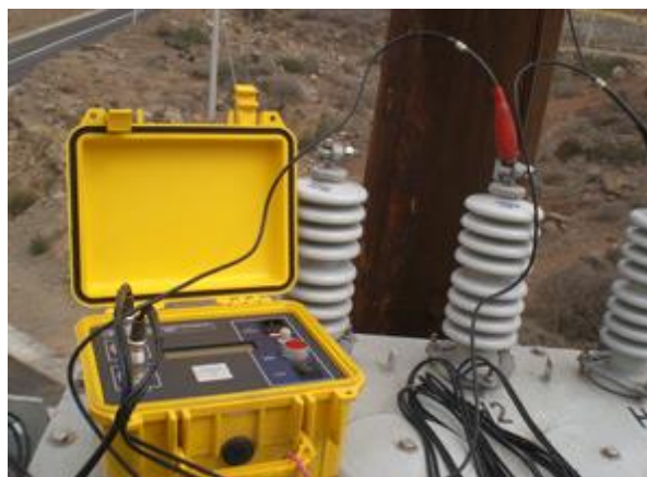
Figura 16: Megger de 15 kV
