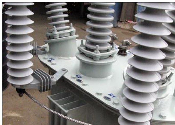
Figura 4: Transformador con pararrayos montados.
