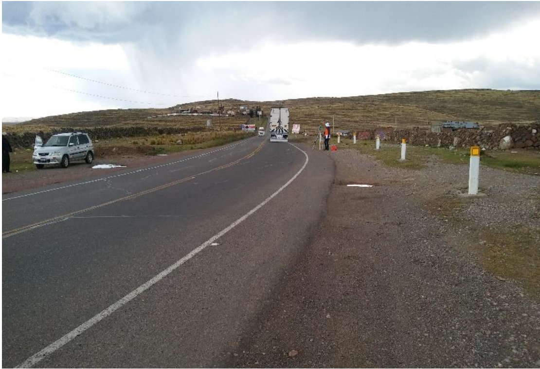
Figura 32. Falta de mantenimiento de los delineadores. TCA-07 Fuente: Elaboración propia
