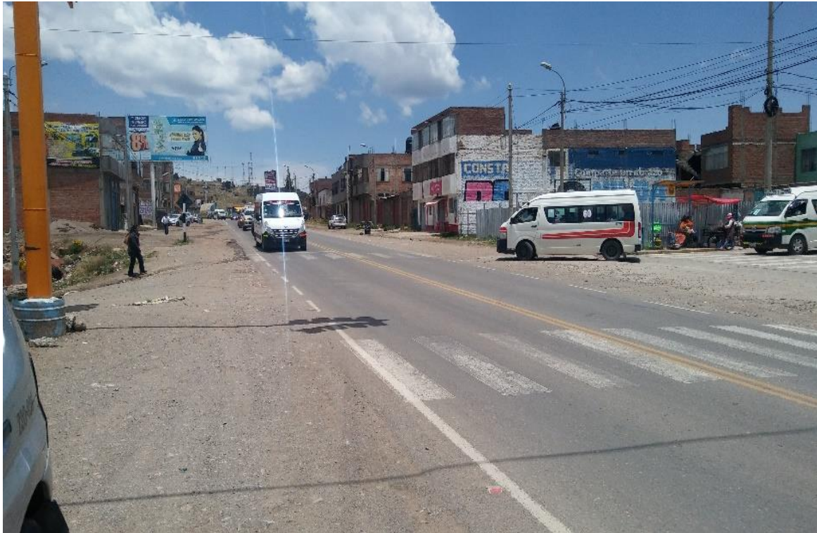
Figura 34. Demarcación horizontal desgastada. TCA-09 Fuente: Elaboración propia
