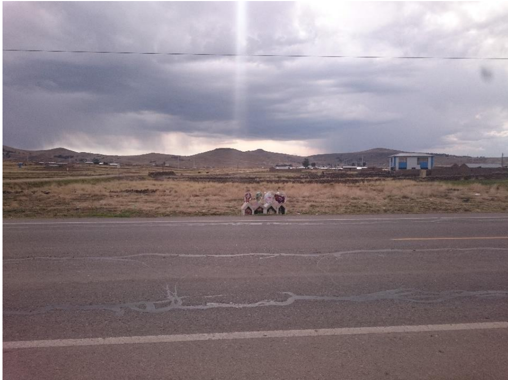
Figura 31. Ausencia de tachas y/o tachones. TCA-06 Fuente: Elaboración propia
