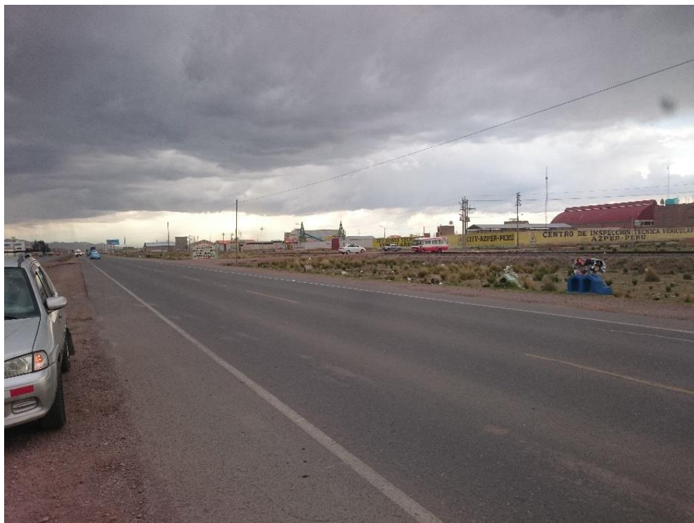
Figura 26. Ausencia y desprendimiento de tachas en líneas borde y centro. TCA-04 Fuente: Elaboración propia
