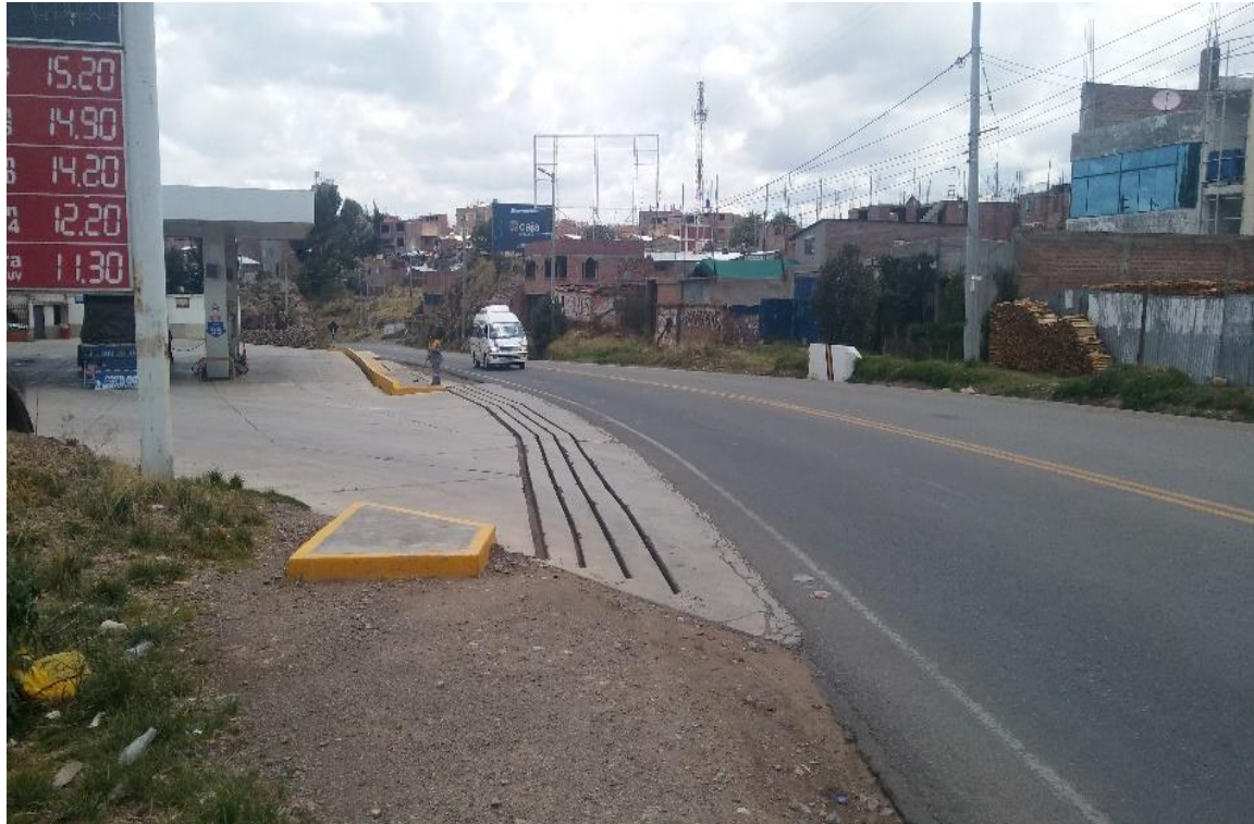
Figura 37. Demarcación horizontal desgastada, reduciendo la retroreflectividad de sus líneas. TCA-10
