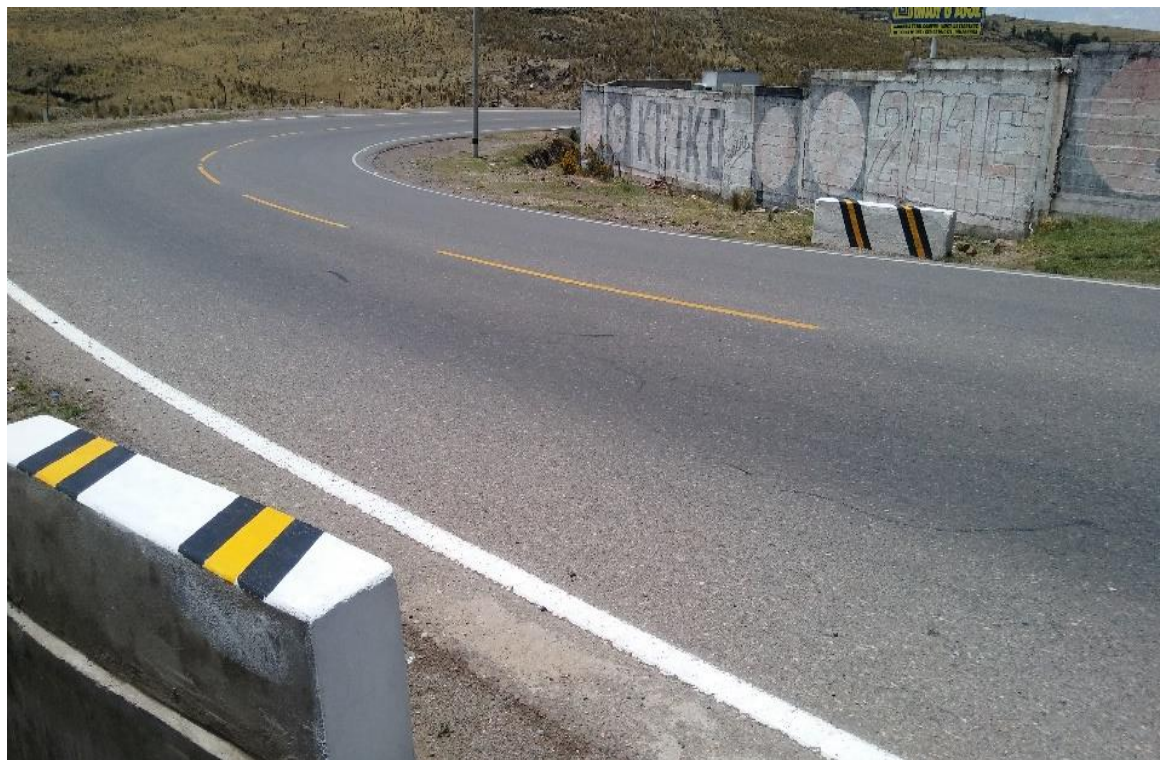
Figura 35. Ausencia de tachas. TCA-09 Fuente: Elaboración propia
