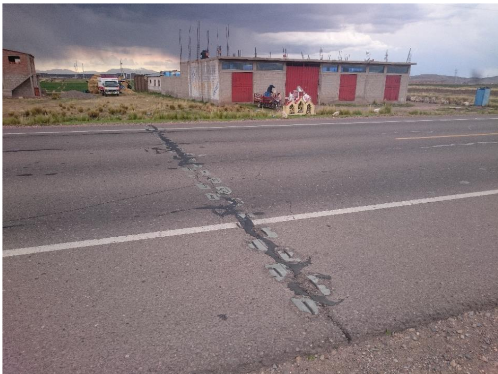
Figura 29. Falta de reductores de velocidad y ausencia de tachas. TCA-05 Fuente: Elaboración propia
