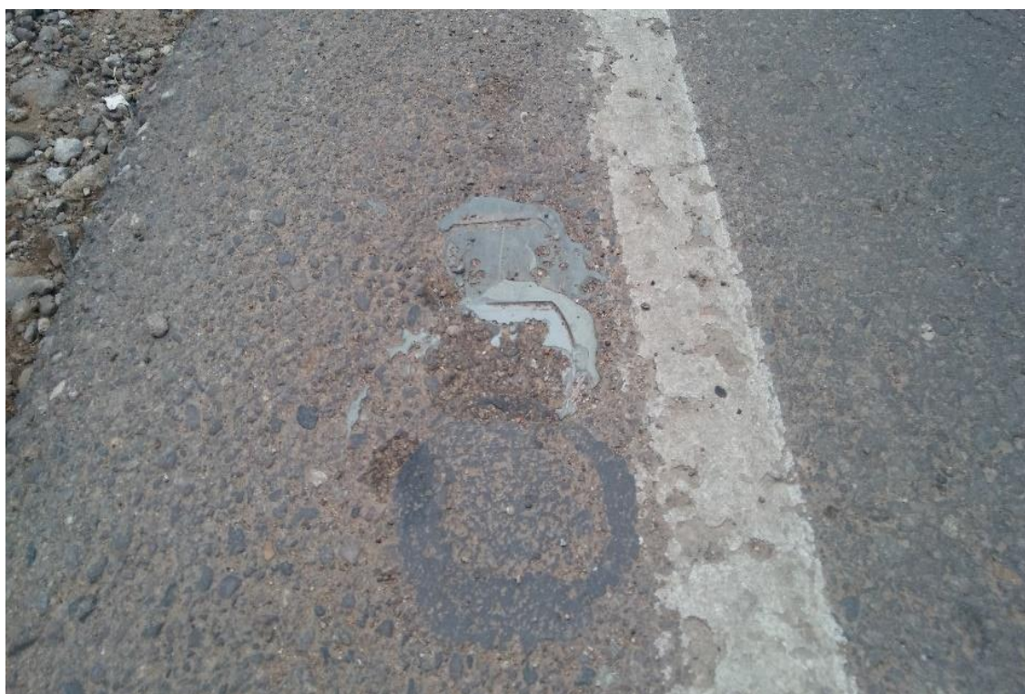
Figura 36. Desprendimiento y ausencia de tachas en líneas de borde. TCA-10 Fuente: Elaboración propia
