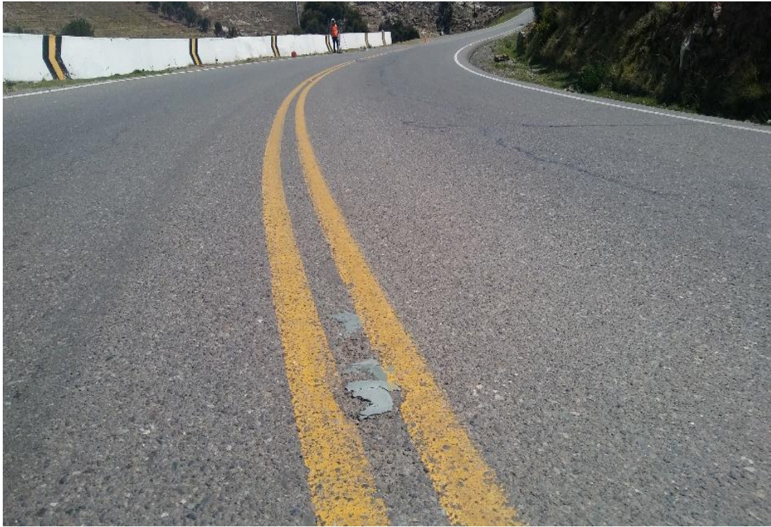
Figura 33. Falta y/o ausencia de tachas. TCA-08 Fuente: Elaboración propia
