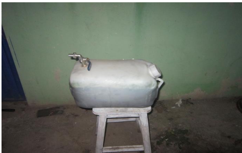
Figura 10. Toma fotográfica del digestor anaeróbico
