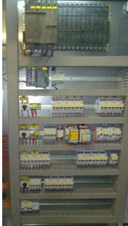
Figura 12. Instalación industrial con control centralizado
