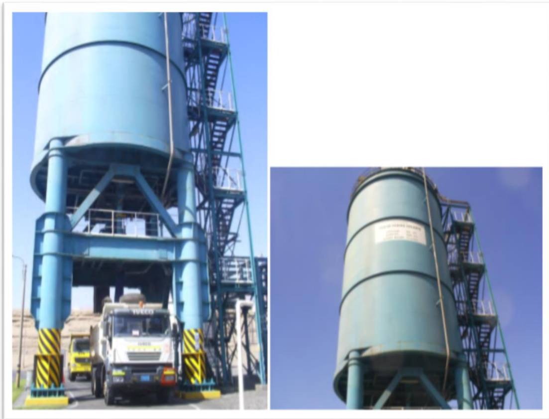
Figura 14 Vista de los Silos donde se Almacena la Ceniza Volante
