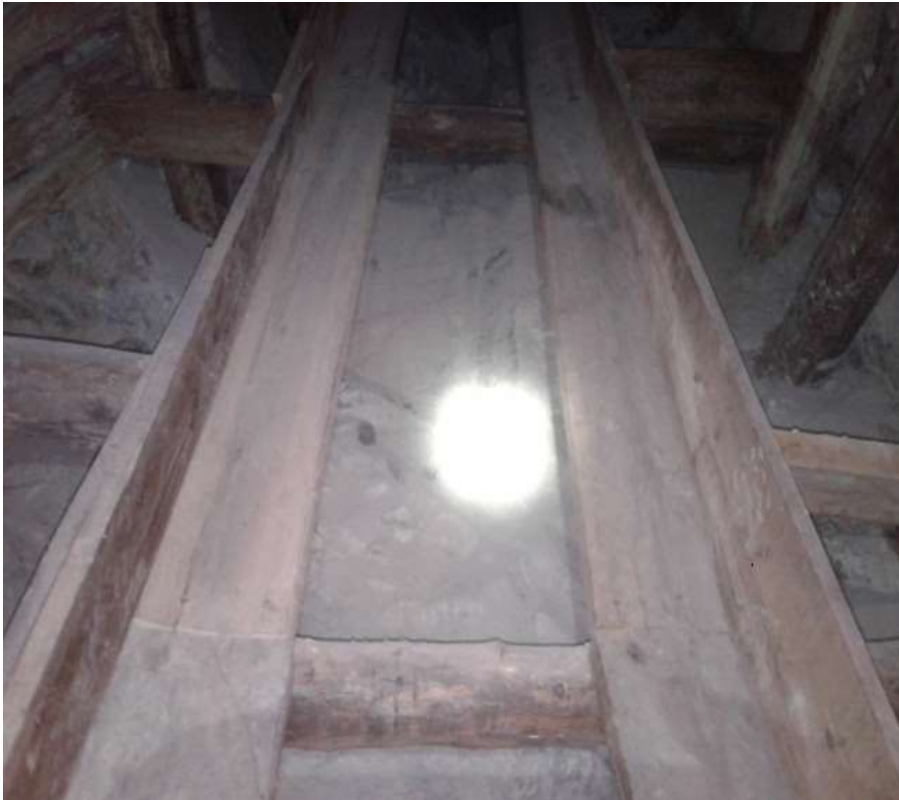
Figura 20. Guiaderas de madera Fuente: Toma de imagen propia (2017)
