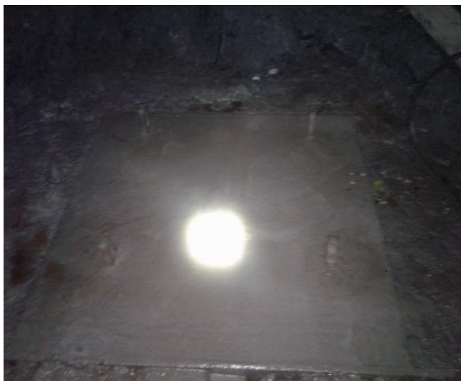
Figura 16. Zapata concreto armado para el anclaje del winche Fuente: Minera la Española S. A.
