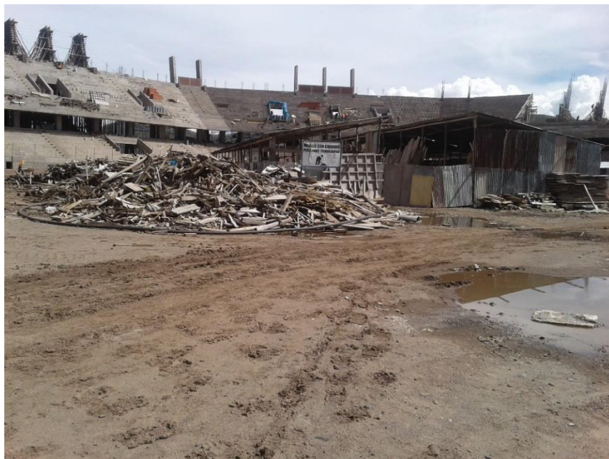
Figura 16. Incumplimiento con la NTP 399.010 Señales de Seguridad.
