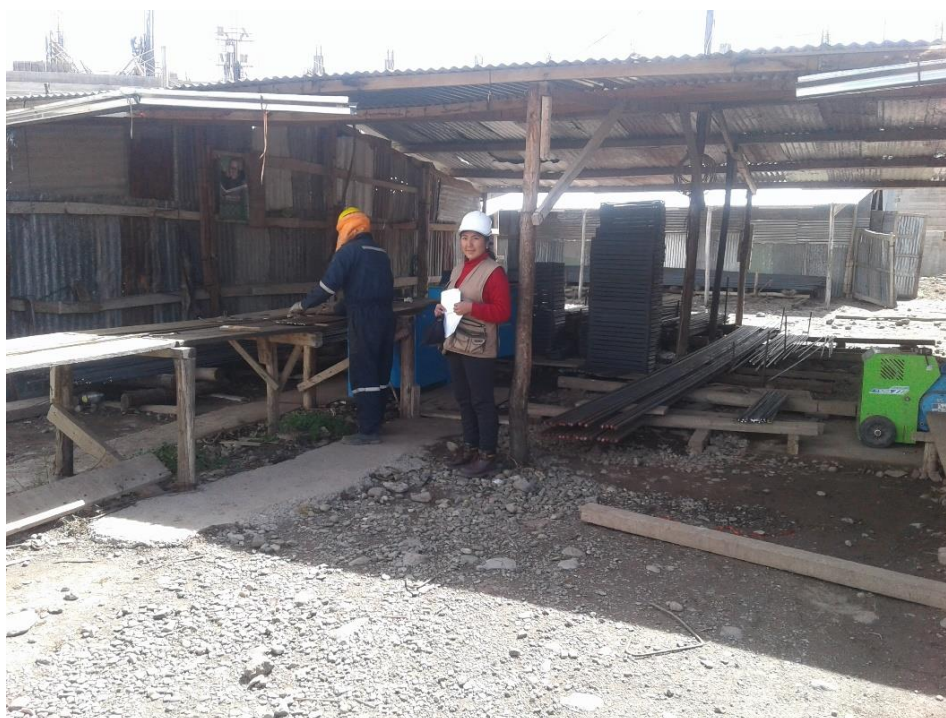
Figura 17. Ausencia de Señalización el Área de Trabajo.
