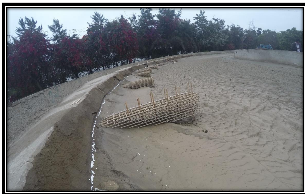
Figura 159: Espigón sometido a socavación en la punta de este. Fuente: Elaboración Propia.
