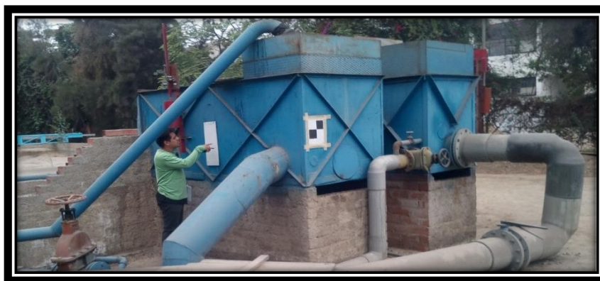
Figura 69: Vista trasera de los tanques metálicos, vertederos abastecedores del canal experimental.
