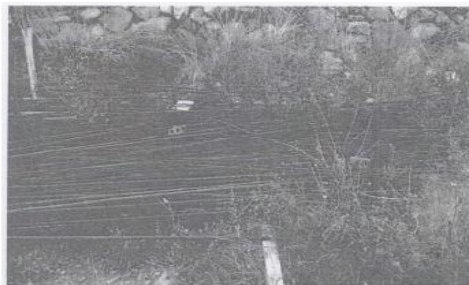
Descripción: Se observa fierros corrugados expuestos a la intemperie los mismos que no se pueden determinar el tiempo de almacenamiento ni su destino.
