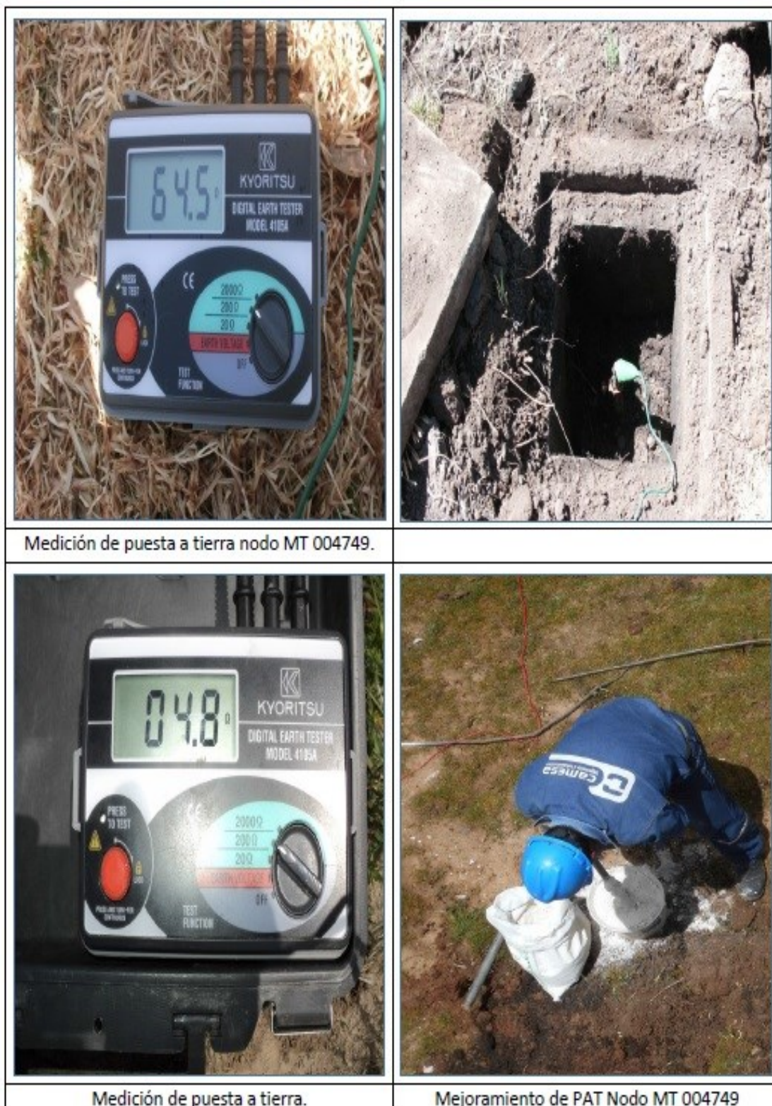
FIGURA E.1: Mantenimiento de puestas a tierra
