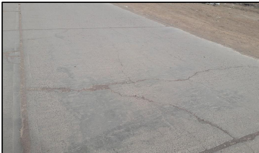
Figura 2. 19.Falla fisura de esquina, Av. circunvalación José Ignacio Miranda (Fuente: Elaboración propia)
