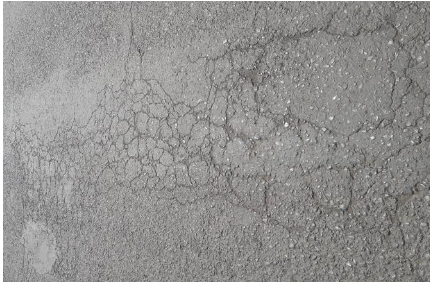
Figura 2. 6. Falla Piel de Cocodrilo, Avenida Tacna. (Fuente: Elaboración Propia).
