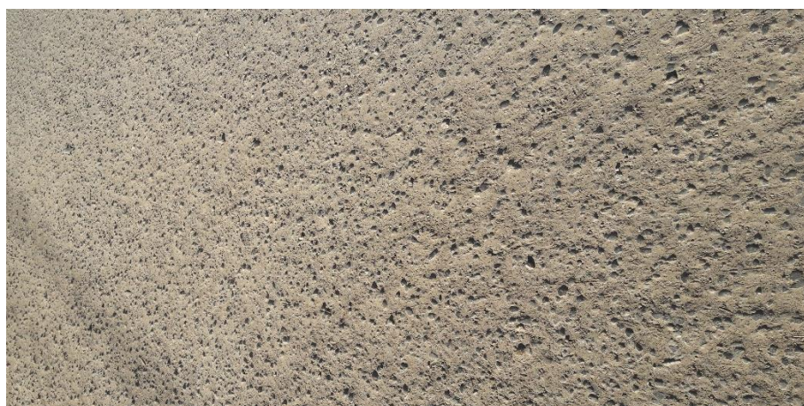
Figura 2. 13.Falla Pulimento de Agregados, Avenida Mariano Núñez (Fuente: Elaboración Propia).
