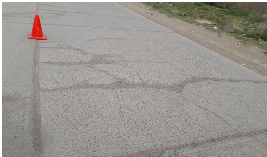
Figura 2. 21.Falla fisuras en bloque, Av. circunvalación José Ignacio Miranda (Fuente: Elaboración propia)
