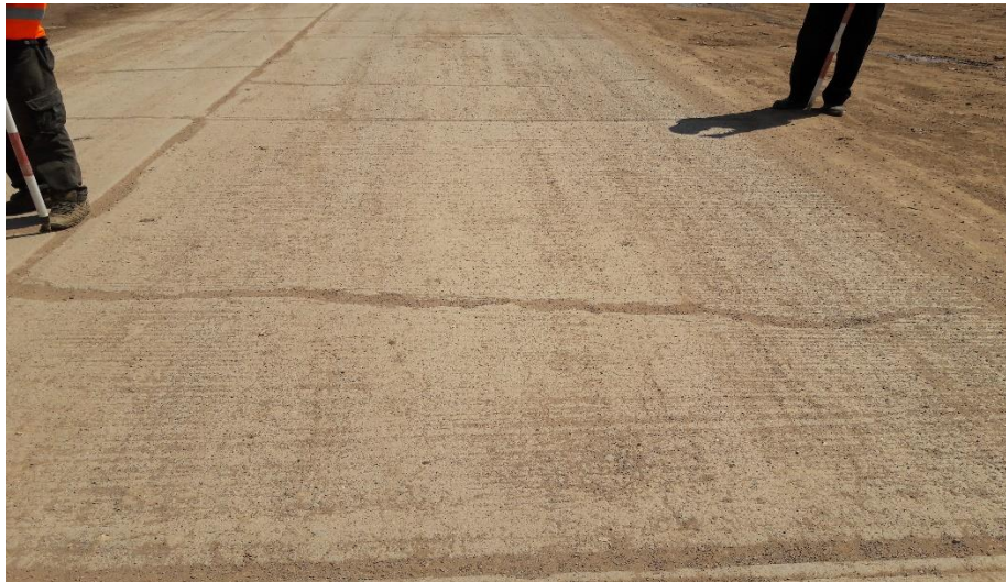
Figura 2. 18.Falla fisura longitudinal, Av. circunvalación José Ignacio Miranda (Fuente: Elaboración propia)
