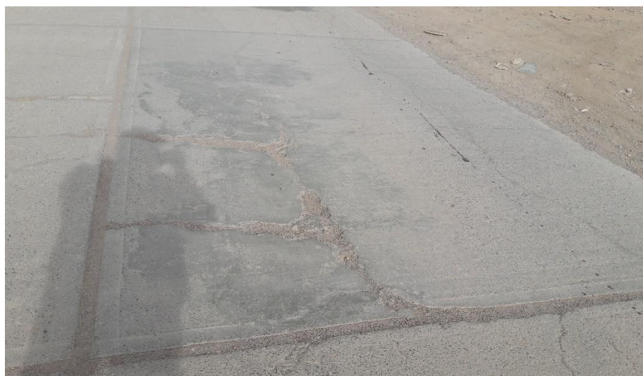
Figura 2. 22.Figura 2. 21. Falla levantamiento de losas, Av. Circunvalación José Ignacio Miranda (Fuente: Elaboración propia)
