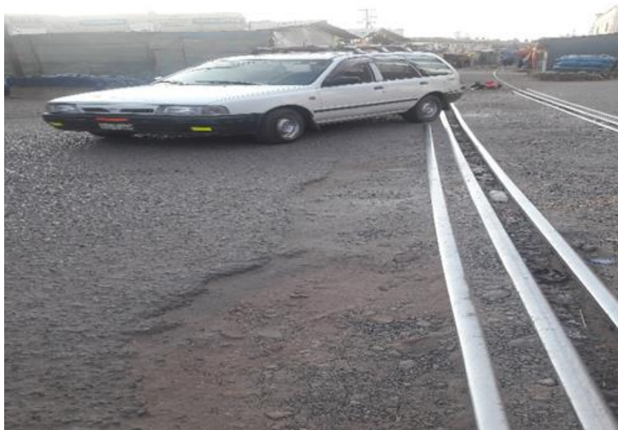
Figura 2. 15. Falla Cruce de vía Férrea, Avenida Mariano Núñez. (Fuente: Elaboración Propia).
