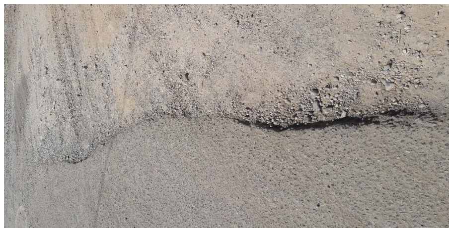
Figura 2. 8.Falla Grieta de Borde, Avenida Circunvalación Sur. (Fuente: Elaboración Propia)
