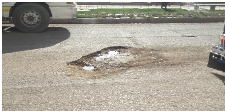
Figura 2. 14. Falla Huecos, Avenida Circunvalación. (Fuente: Elaboración Propia).
