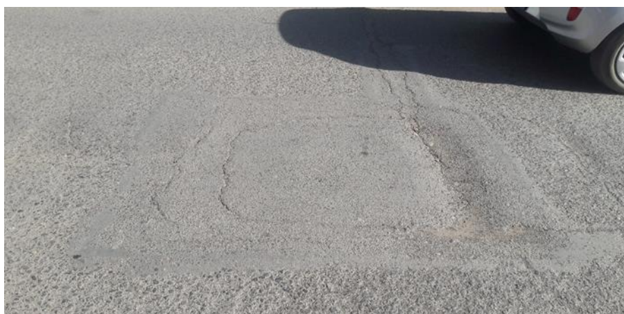
Figura 2. 12. Falla Parcheo y Acometidas de servicio públicos, Avenida Tacna. (Fuente: Elaboración Propia).
