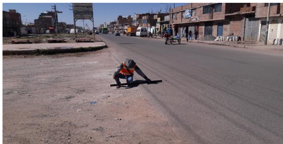
Figura 2. 10. Falla Desnivel carril berma, Avenida Circunvalación Sur. (Fuente: Elaboración Propia).
