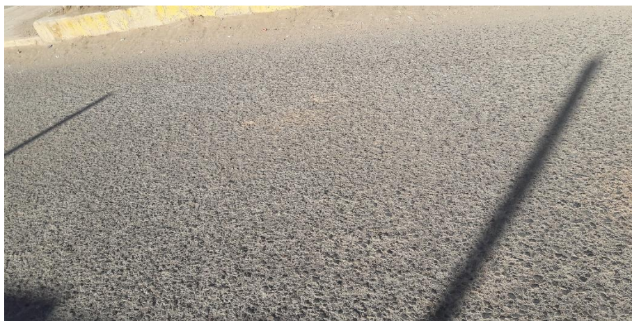
Figura 2. 16. Falla Desprendimientos de Agregados, Avenida Mariano Núñez. (Fuente: Elaboración Propia).
