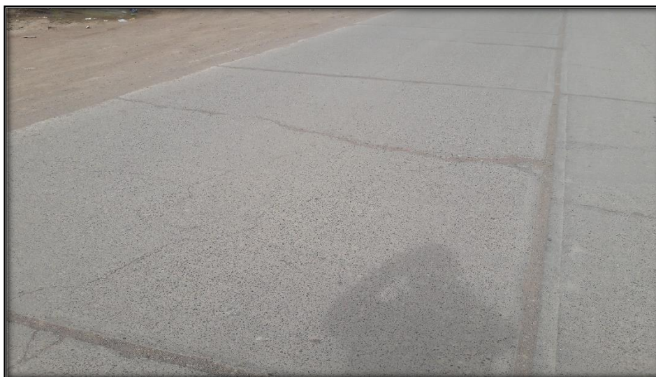
Figura 2. 17. Falla fisura transversal o diagonal, Av. circunvalacion Jose Ignacio Miranda (Fuente: Elaboracion propia)
