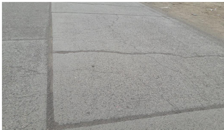
Figura 2. 23. Dislocamiento, Av. circunvalación José Ignacio Miranda (Fuente: Elaboración propia)
