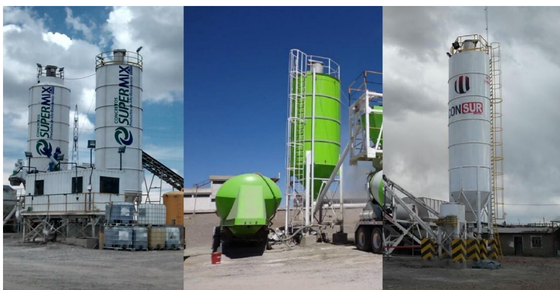
Figura 40 : Silos de Cemento en las diferentes Plantas Dosificadoras. Fuente: Elaboración Propia
