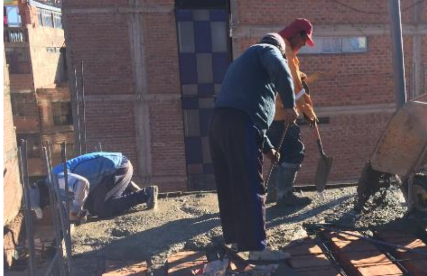
Figura 61 : Consolidación de concreto con varilla corrugada de fierro (Chuseo) Fuente: Elaboración Propia
