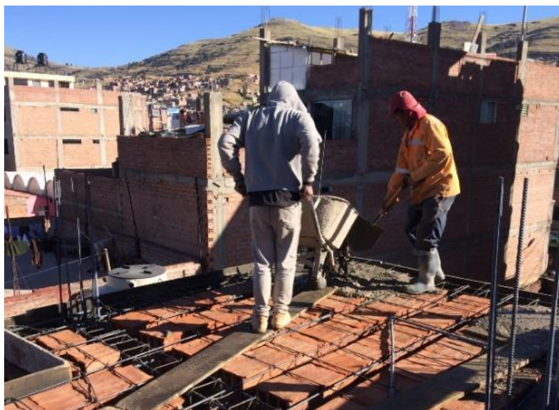
Figura 60 : Uso de buggie para transporte de concreto “In Situ” Fuente: Elaboración Propia
