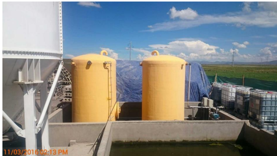
Figura 42 : Almacenaje de Aditivo en Silos – Concretos SuperMix S.A. Fuente: Elaboración Propia
