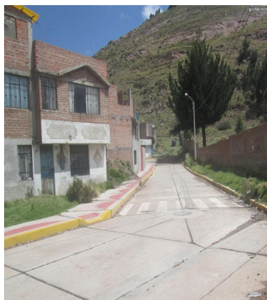
SOBREMETA: AL FINALIZAR LA ULTIMA CUADRA DEL JR DE LA AMISTAD, SE CONSTRUYERON 50 METROS MAS.
