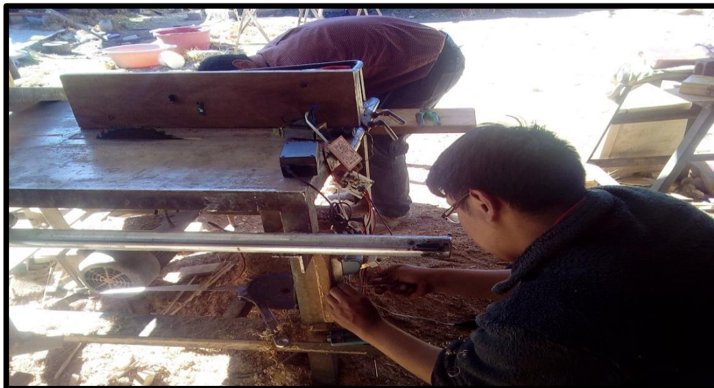
Instalado del variador de frecuencia al motor monofásico.
