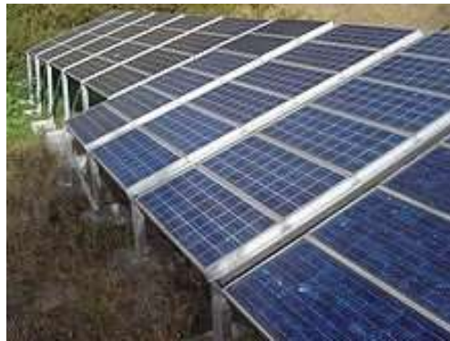
Figura 5. Batería de paneles solares
