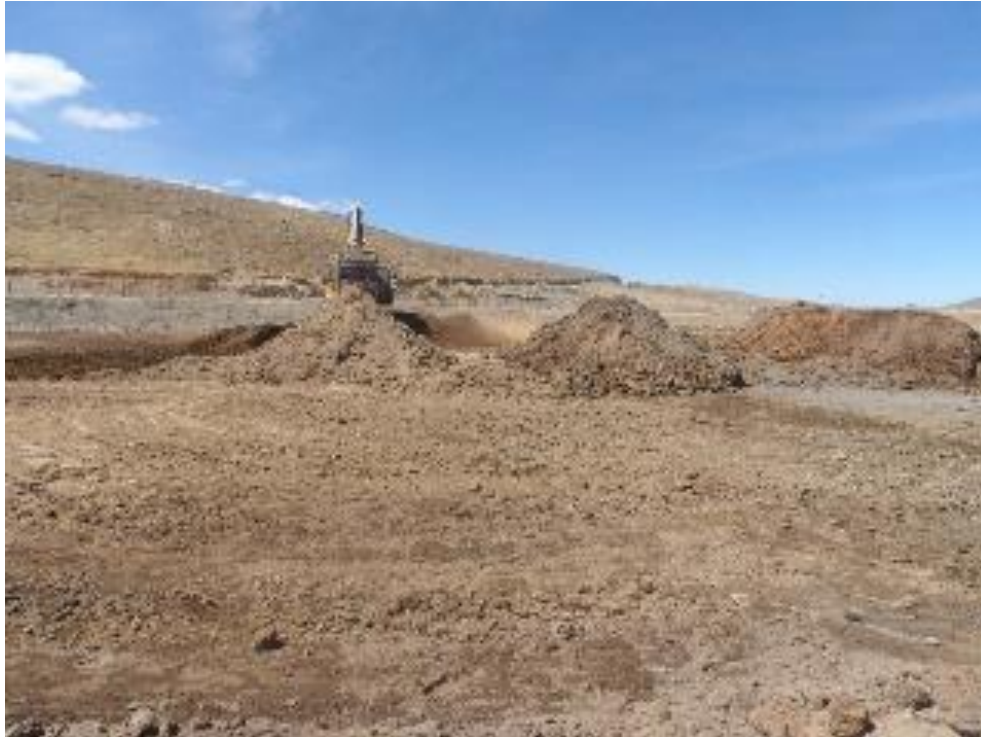
Acumulación del material contaminante.
