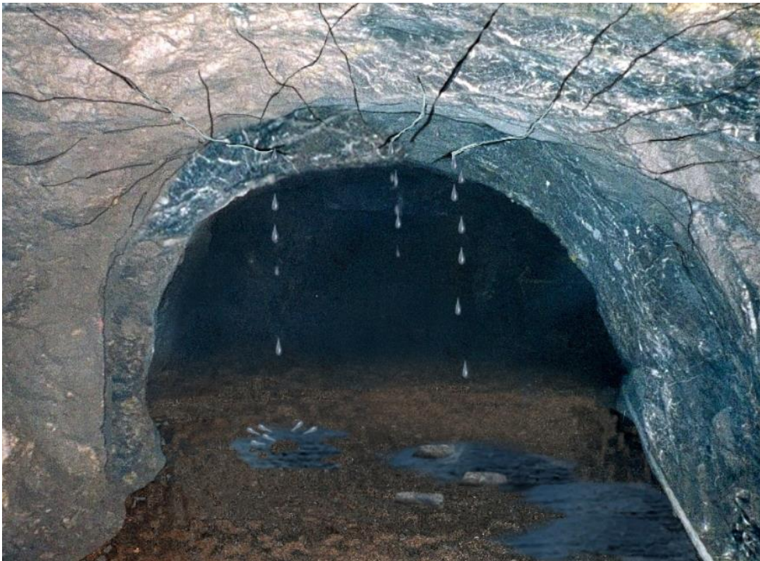
Figura 6. Presencia de agua en labor subterránea
