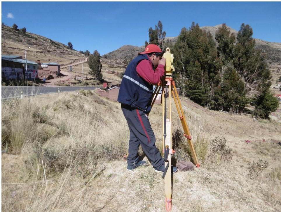
Fotografía N°2: En la imagen se observa el levantamiento topográfico del cauce de la quebrada
