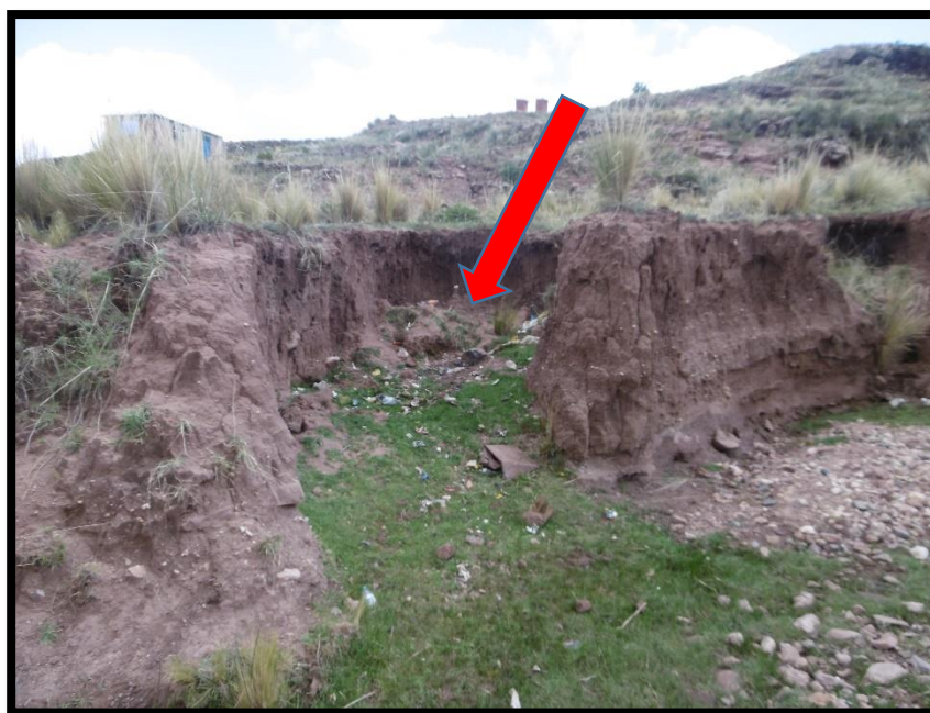
Figura 6: Movimiento en masa en el talud lateral de la cárcava. Fuente: Propia, 2018.
