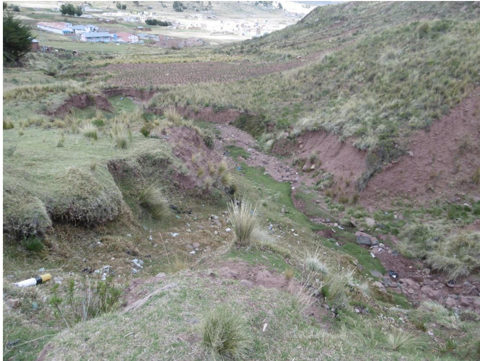
Fotografía N°7: En la imagen se observa el cauce o cárcava de la microcuenca Sonocco.
