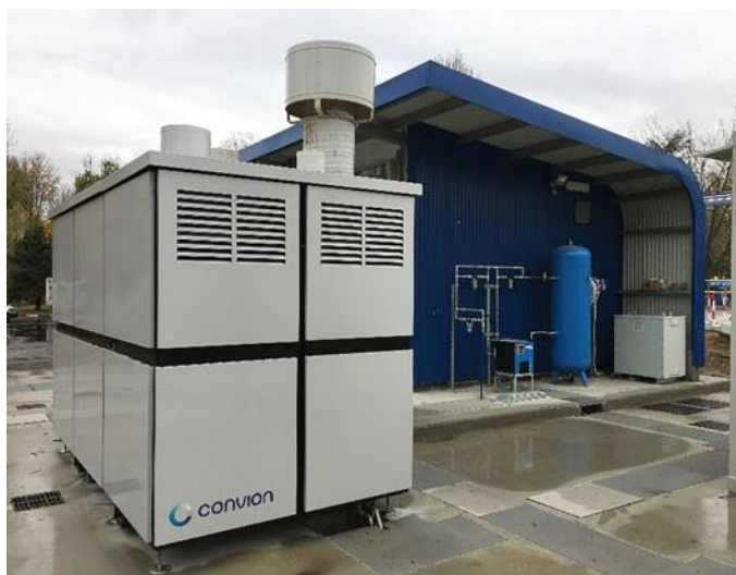
Figura N° 4.42 Módulo del primer Convion C50 SOFC iniciado en Turín.
