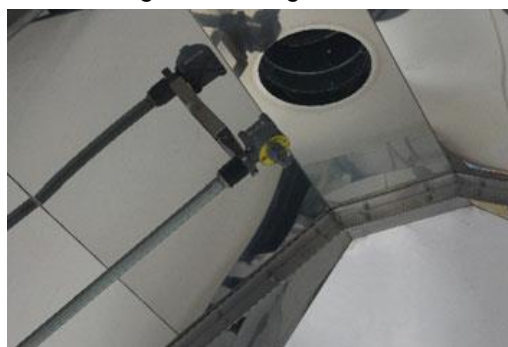
Figura N° 4.44 Detector de gas de hidrógeno instalado en un laboratorio.
