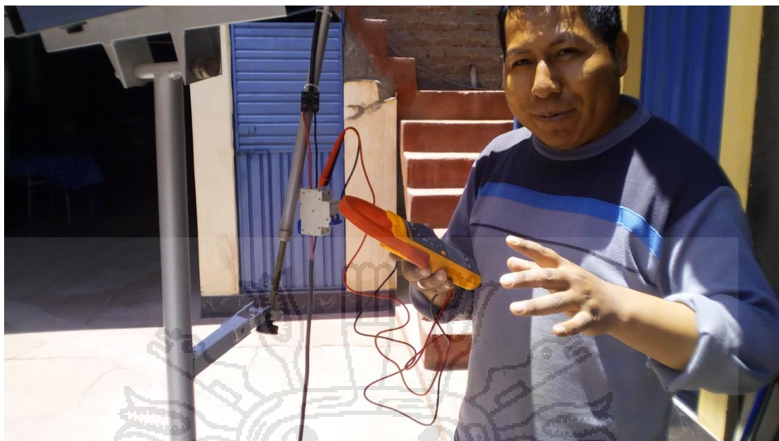
Realizando la medición de parámetros eléctricos en el módulo solar fotovoltaico.
