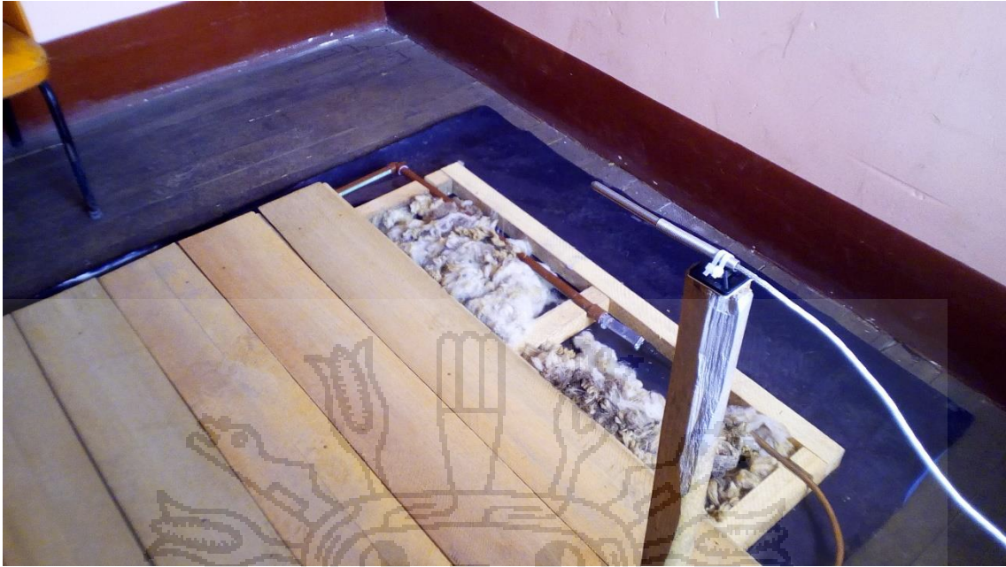
Ubicando el sensor de Temperatura PT – 100 a 60cm de altura.
