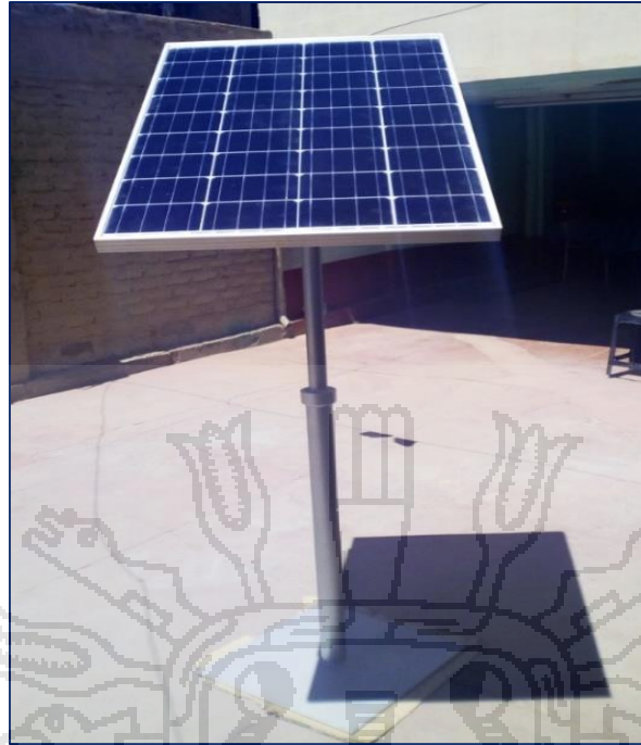
Figura 47. Modulo Solar Fotovoltaico instalado en Juliaca. Fuente: Elaboración propia
