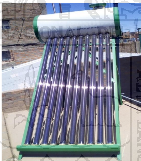
Figura 48. Colector Solar Térmico instalado en Juliaca. Fuente: Elaboración propia
