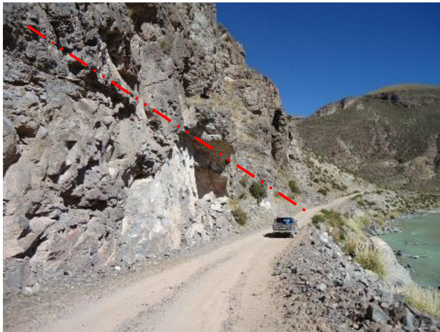
Imagen 9 SE OBSERVA FALLA TRANSVERSAL AL TRAZO
